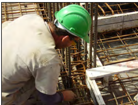
Figura 3.49 – Encontro da armadura da viga e do pilar: grande quantidade de barras e a dificuldade do armador em recolocar os estribos.
