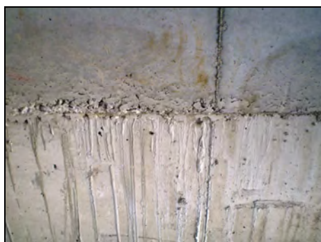
Figura 3.9 – Pilar concretado com perda de água e finos de cimento, devido a frestas com dimensões acima da tolerância.
