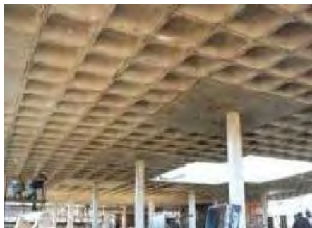
Figura 3.4 – Rugosidade de uma laje executada com molde plástico (após desforma).
