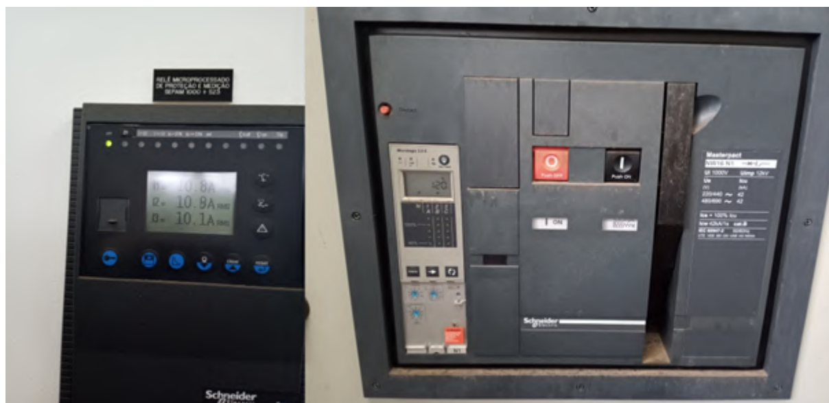
Figura 9: Relé de proteção e Disjuntor principal da unidade consumidora IFSC - I.
