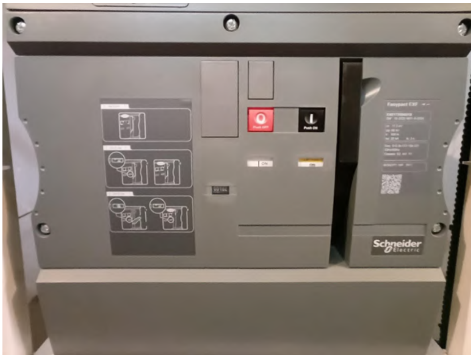
Figura 12: Disjuntor principal da unidade consumidora IFSC - II.
