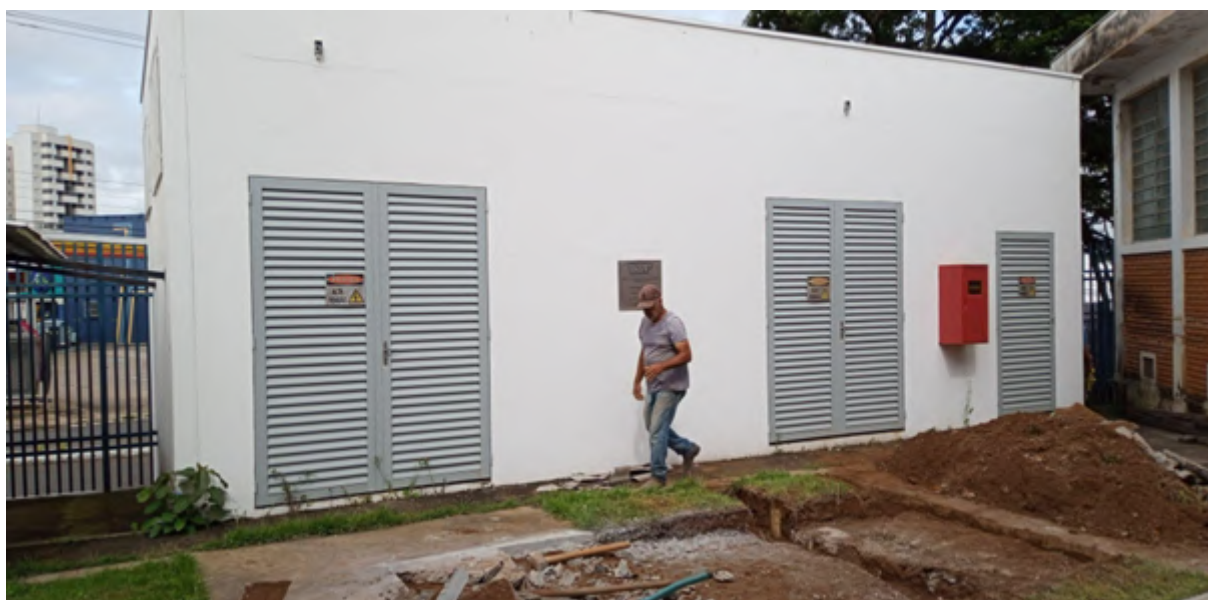
Figura 7: Vista da unidade consumidora IFSC - I.
