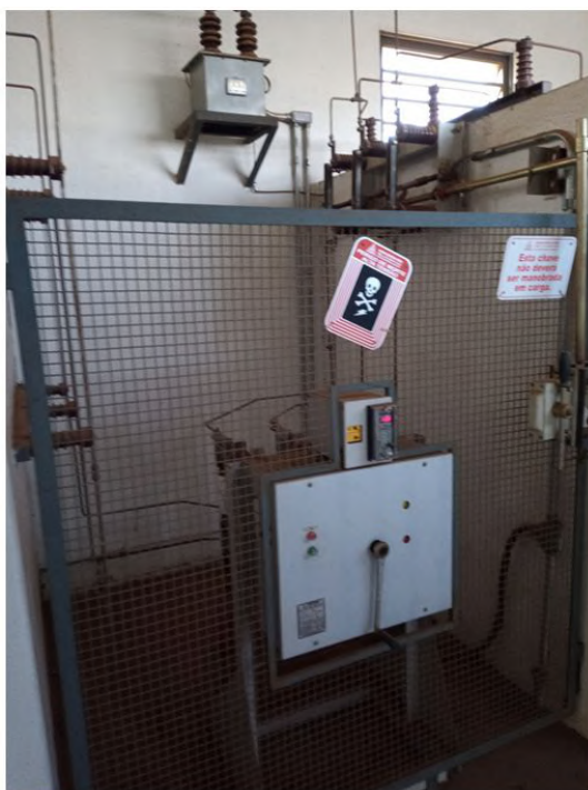
Subestação Principal lado de Alta Tensão
