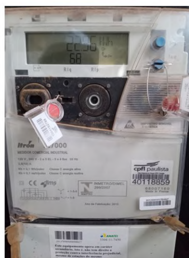
Medidor da subestação principal
