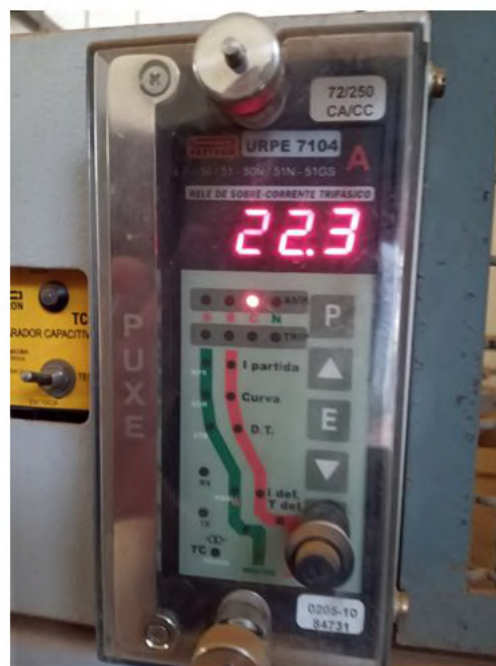
Relé da subestação principal
