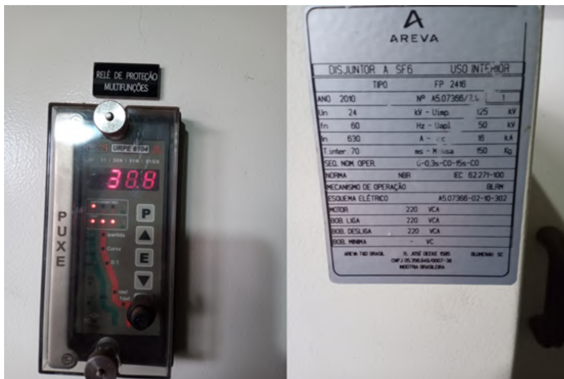
Figura 6: Relé de proteção e Disjuntor principal da unidade consumidora Área Sul.
