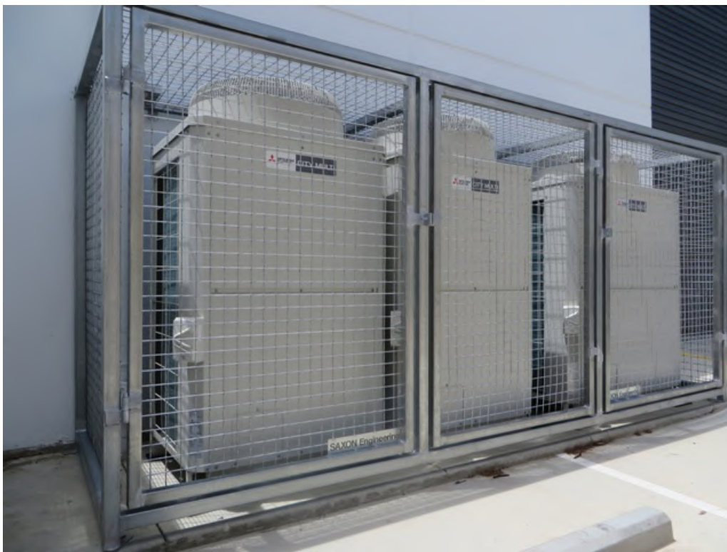
Figura 16: Grade para proteção contra furto dos inversores.
