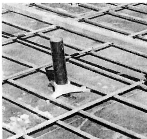
Figura nº 67 – Peça de eletroduto passante na laje
