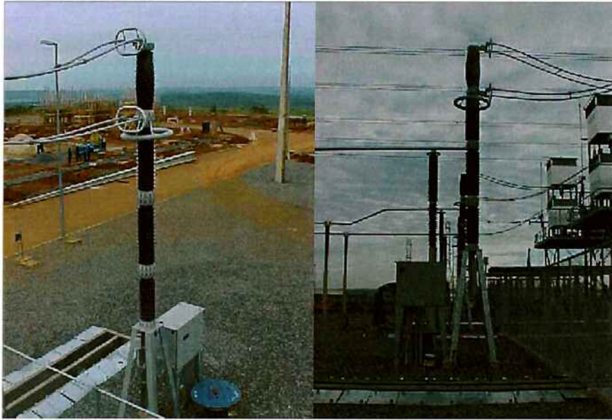
Figura 11 - Foto de um disjuntor de bypass
