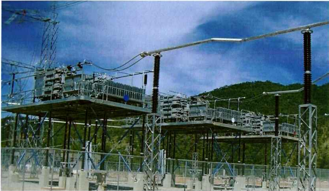
Figura 4 - Bancos de capacitores série mostrando as três fases instaladas em 500kV
