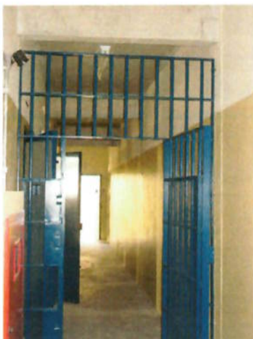
Foto 3 – Incompatibilidade de projeto estrutural com as esquadrias
