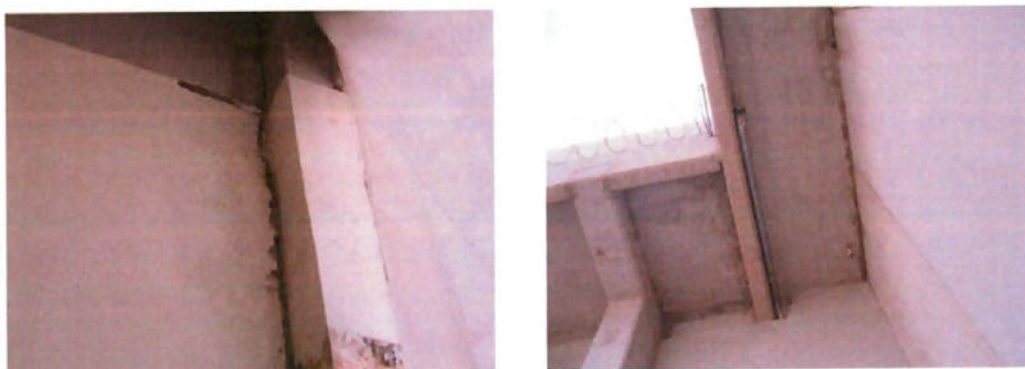
Foto 34 – Parede e pilar do almoxarifado (esquerda) e umidade por baixo do passeio da muralha (direita).
