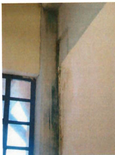
Foto 32 – Infiltrações no corpo da guarda.
