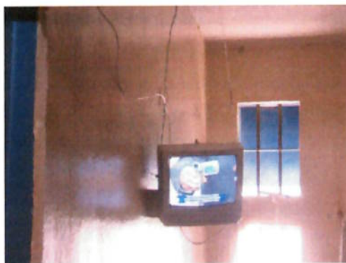
Foto 4 – Instalações elétricas irregulares
