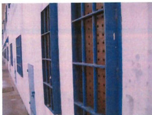
Foto 43 - Placas de aço nas janelas.
