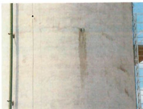
Foto 23 – Vazamentos na caixa d'água.
