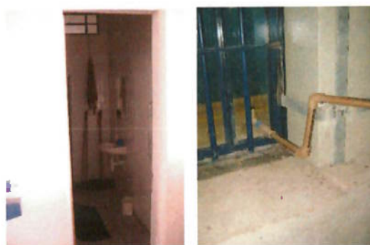
Foto 42 – Banheiro modificado no almoxarifado (esquerda) e tubulação improvisada na galeria (direita).
