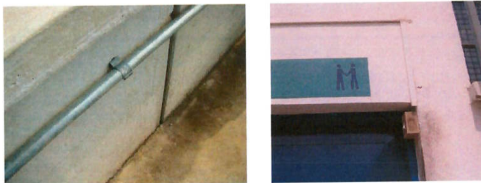
Foto 39 - Tubulação e abraçadeiras no passeio da muralha (esquerda) e campainha improvisada na ante-muralha (direita).
