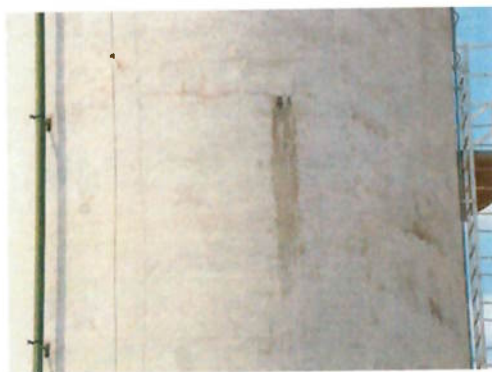
Foto 33 – Vazamento da Caixa d'água.
