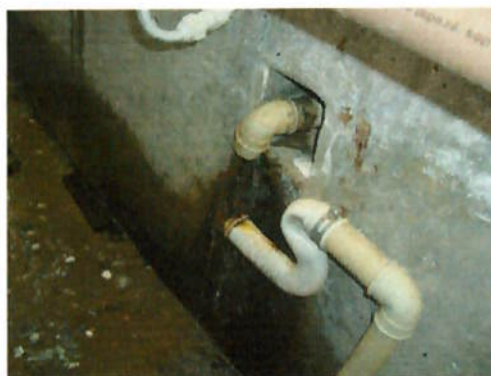
Foto 5 – Problema hidráulico originado pelo vandalismo
