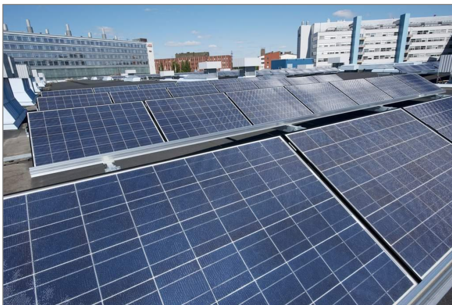
Figura 4: Sistema fotovoltaico de geração de energia elétrica
