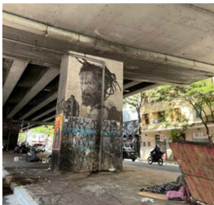
▶ Figura 22. Situação da marquise do Elevado, na altura da Alameda Nothmann, sentido bairro. (Fonte: Autor, 2024).
