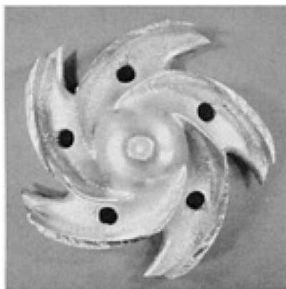
Figura 11: Erosão-corrosão numa hélice de bomba para lama de cal.
