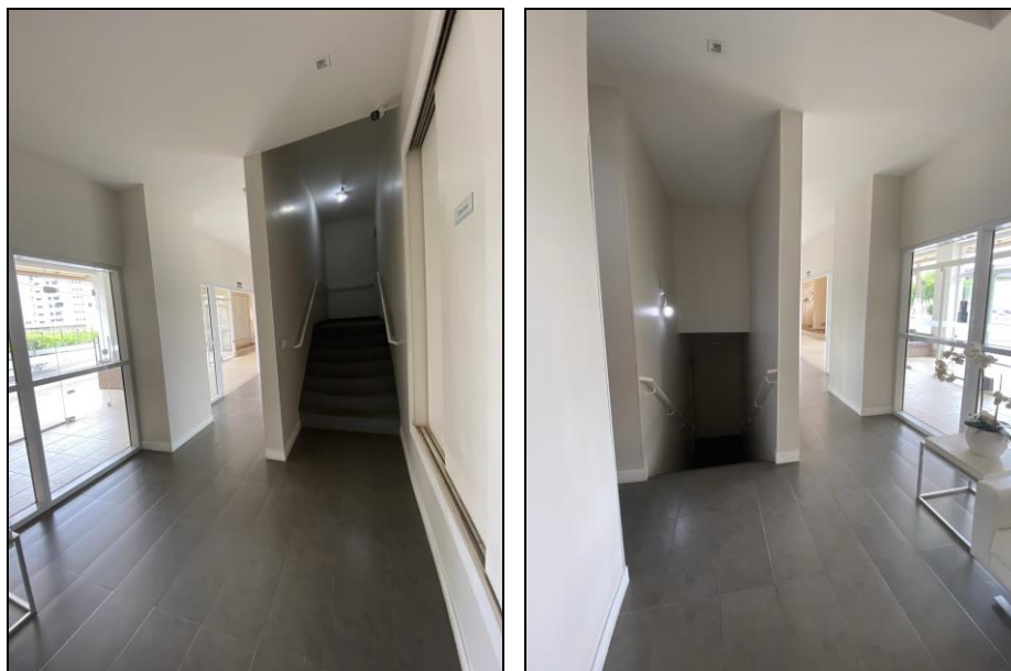
Figura 11 – Término das escadas de emergência no pavimento térreo
