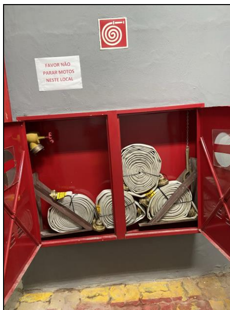
Figura 22 – Abrigo de hidrante sem esguicho
