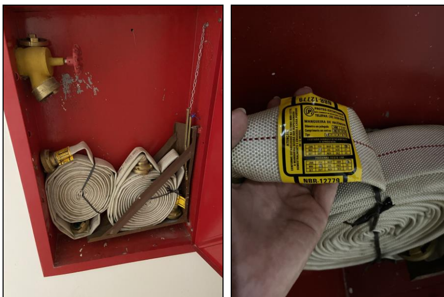
Figura 23 – Detalhe das mangueiras dos hidrantes
