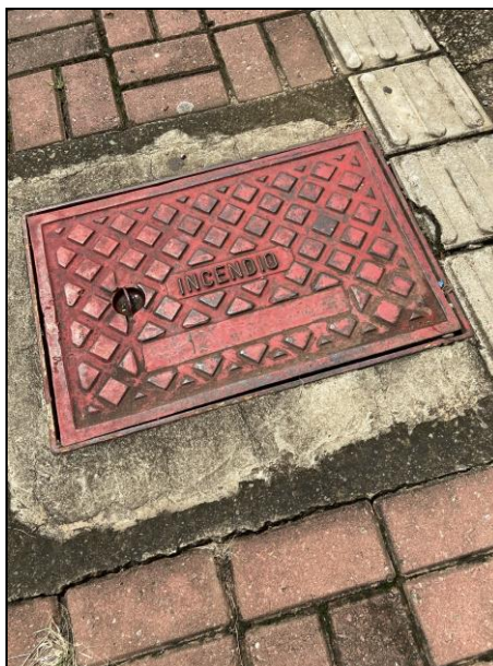
Figura 19 – Sinalização de hidrante de recalque em cor similar à do piso
