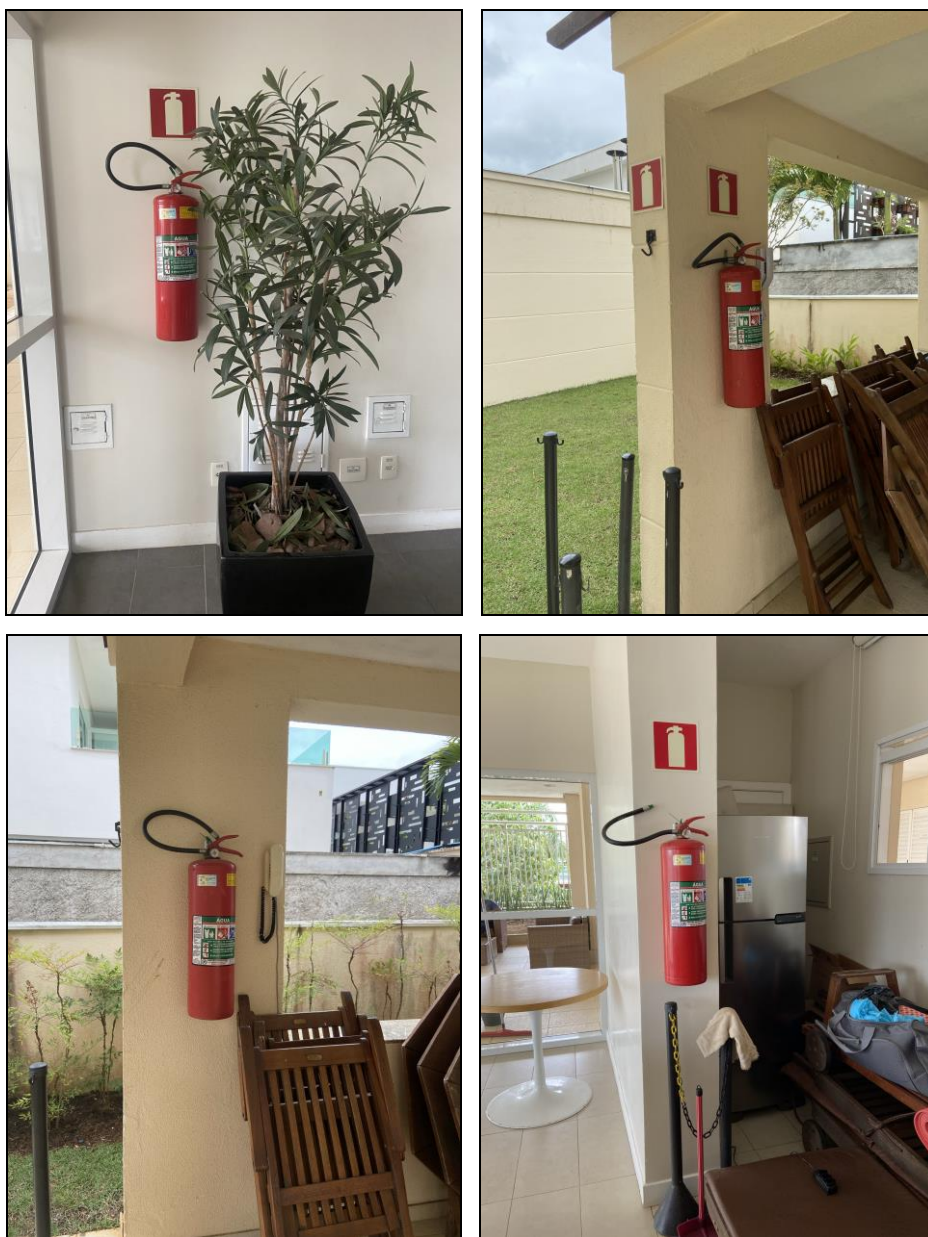
Figura 20 – Extintores obstruídos no pavimento térreo
