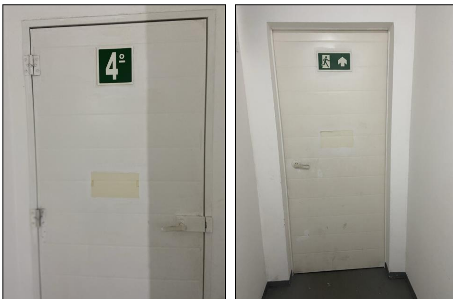
Figura 16 – Ausência de sinalização complementar em portas corta-fogo
