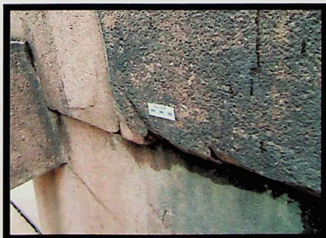
Figura 11. Base de granito com deposição superficial; quina quebrada e fraturada.
