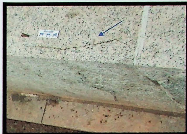
Figura 2. Rachadura e plaqueta no granito da base.
