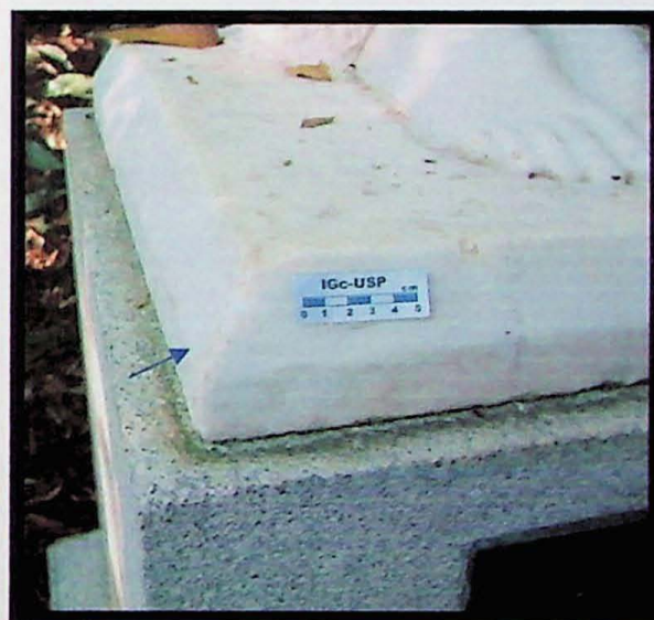
Figura 4. Quina do mármore apresenta-se desgastada.
