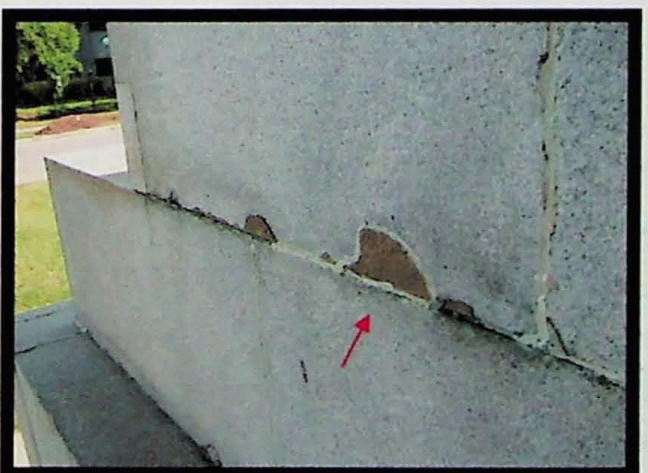
Figura 11. Argamassa usada grosseiramente na reparação de lacunas.
