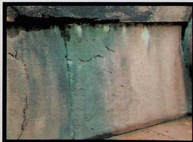
Figura 12. Granito com escamação; e mancha verde, devido à lixiviação do bronze.
