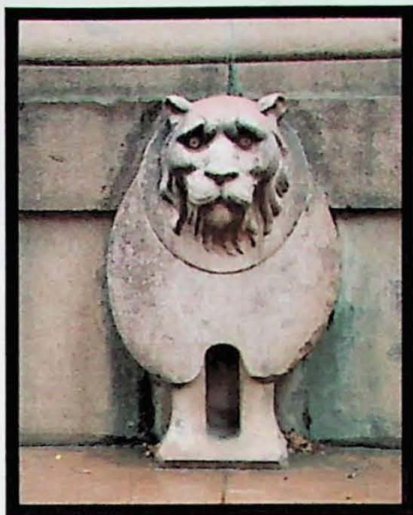
Figura 7. Leoa com manchas escuras, devido à maior umidade dada a presença da árvore que encobre a luz solar.
