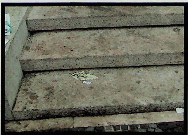
Figura 5. Manchas nos degraus de granito. Argamassa preenchendo lacunas.
