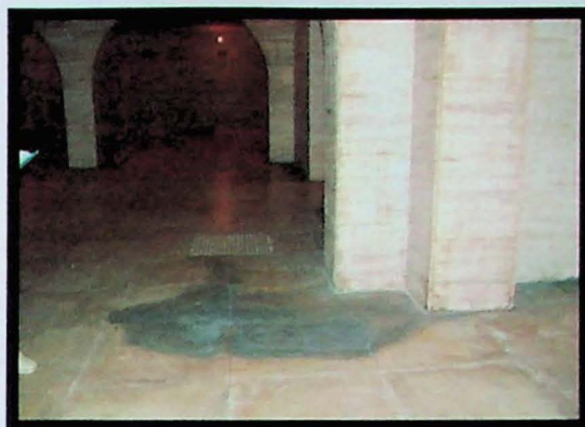
Figura 8. Chão manchado com água infiltrada.
