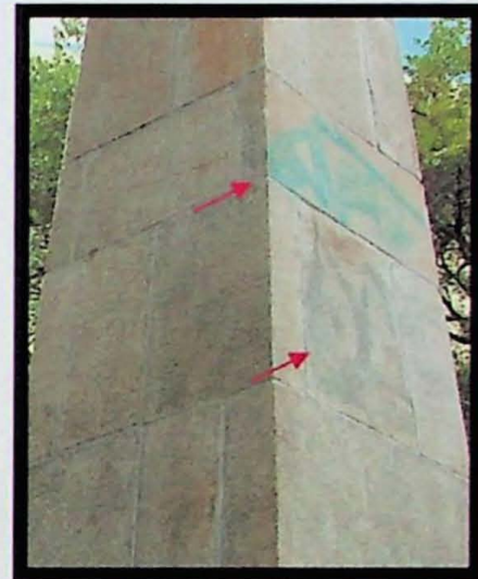
Figura 4. Vestígios de pichação (após limpeza), na porção intermediária da obra.
