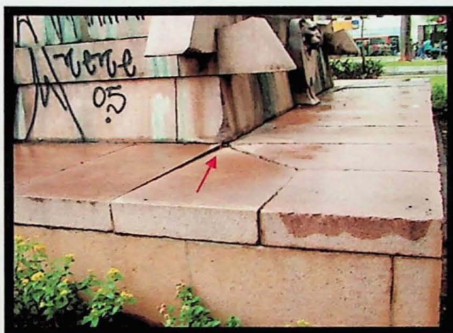
Figura 9. Problemas de recalque da estrutura do monumento.
