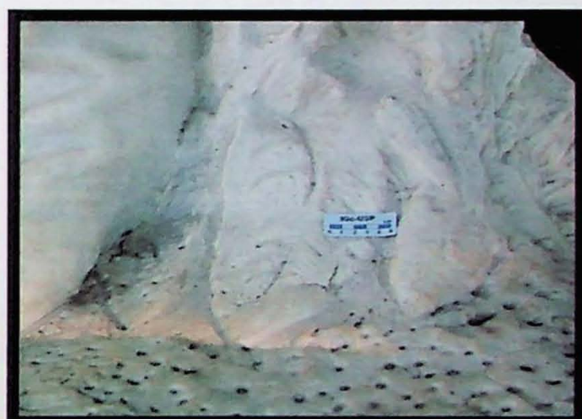
Figura 4. Superfície com alveolização e depósito superficial de fuligem.
