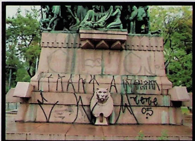
Figura 6. Base pichada e com deposição superficial de carbonato de cobre.
