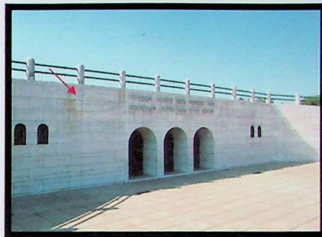
Figura 2. Parte externa: travertino manchado.
