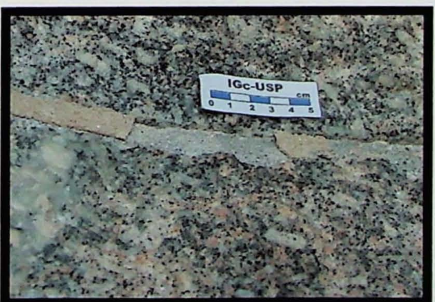
Figura 11. Rejunte mais "novo" descascando e expondo o mais "antigo".
