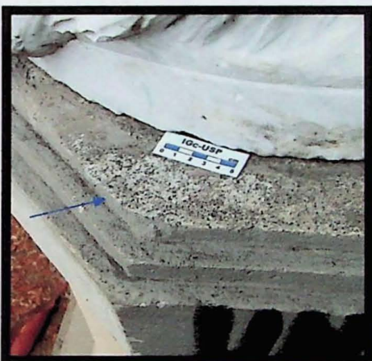
Figura 3. Quina quebrada da base.
