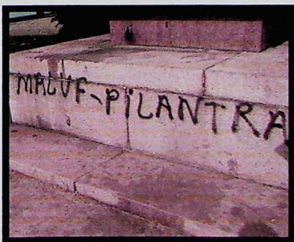
Figura 5. Base de granito com manchas e pichada.
