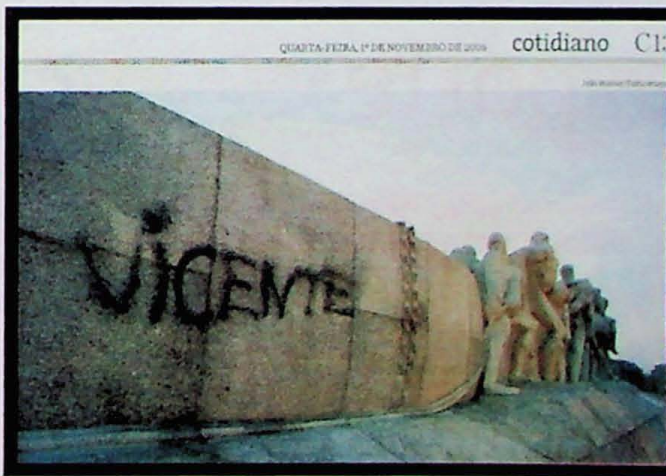
Figura 18. Outubro de 2006: obra novamente pichada.
