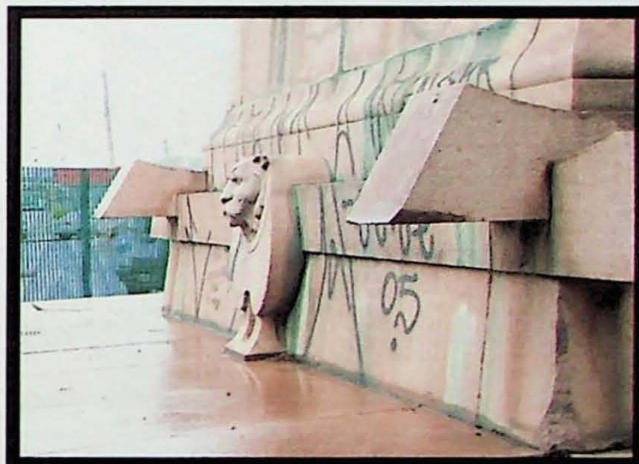
Figura 4. Lateral esquerda da obra: pichada e manchas verdes. Quina quebrada, na porção direita inferior da foto.
