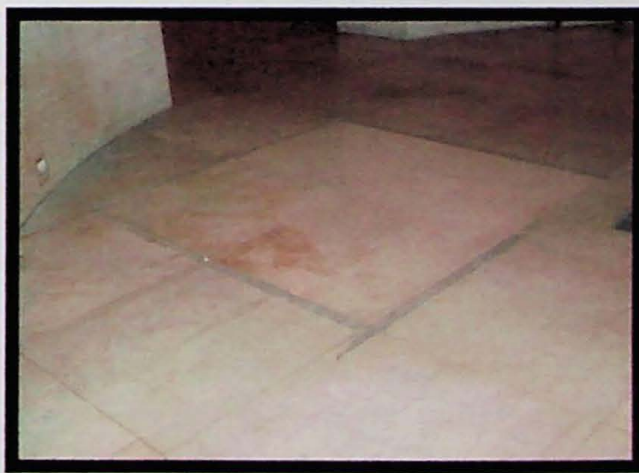
Figura 6. Chão apresentando manchas devido à infiltração.
