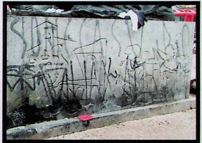
Figura 4. Granito desgastado pela ação da queima de velas.
