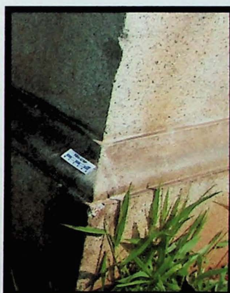
Figura 10. Quina da base quebrada.
