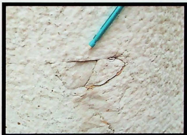
Figura 3. Fratura na base da obra.
