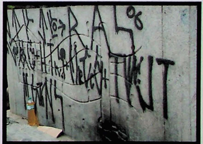
Figura 6. Lixo doméstico ao redor da obra; base de granito pichada com spray preto.
