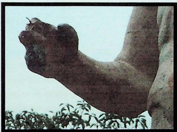
Figura 3. Mão direita sem os dedos. Notar a armação da estrutura exposta.
