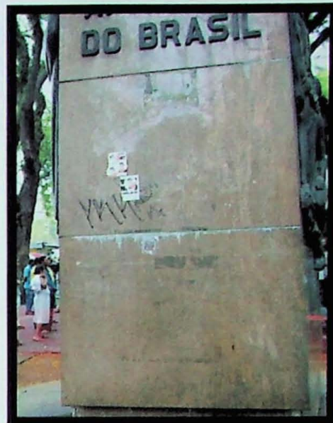
Figura 2. Lixiviação de argamassa do rejunte, adquirindo coloração esverdeada.
