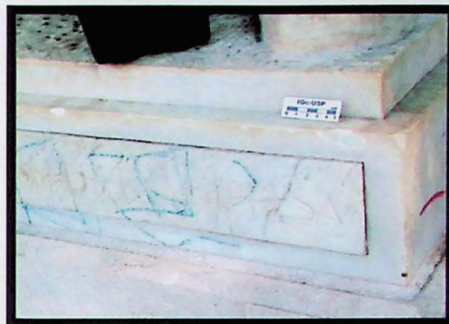
Figura 2. Base pichada e quinas quebradas.
