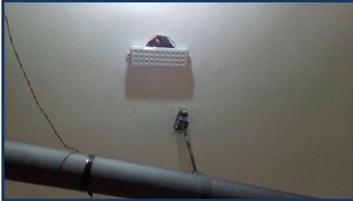
Figura 22 – Detalhe das luminárias presentes no subsolo da edificação.
