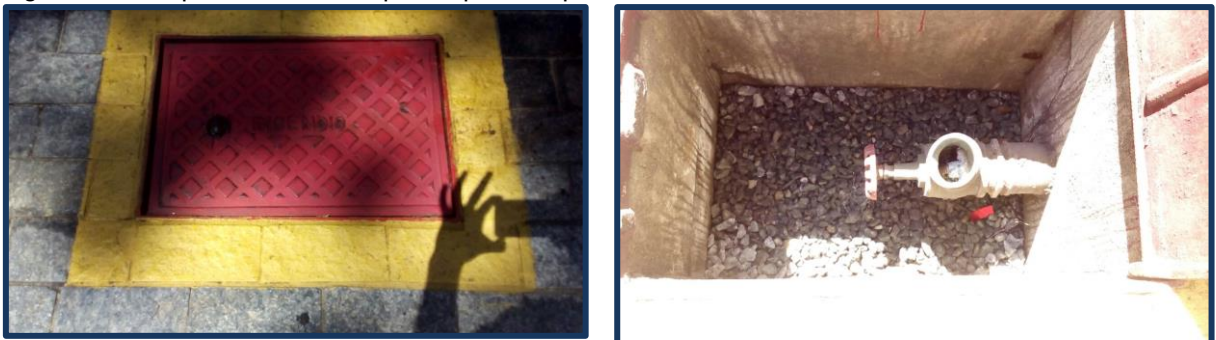
Figura 42 – Dispositivo de recalque no passeio público.
