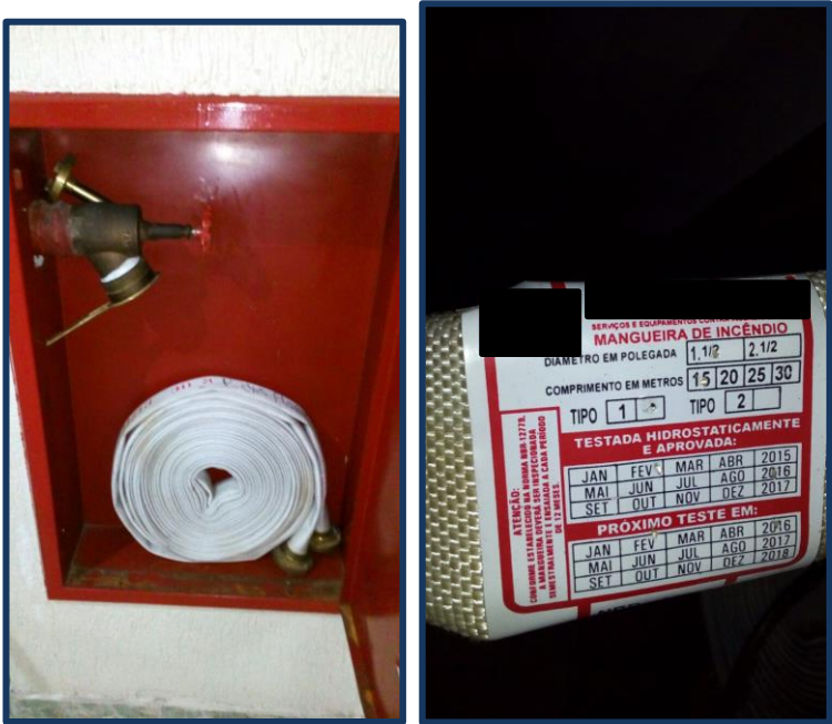
Figura 38 – Detalhes dos hidrantes dos andares tipos – com o abrigo aberto.
