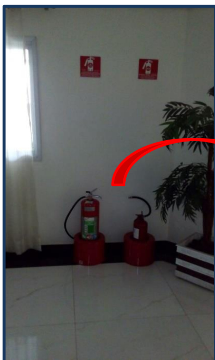
Figura 21 – Extintores no Hall do andar térreo da edificação.
