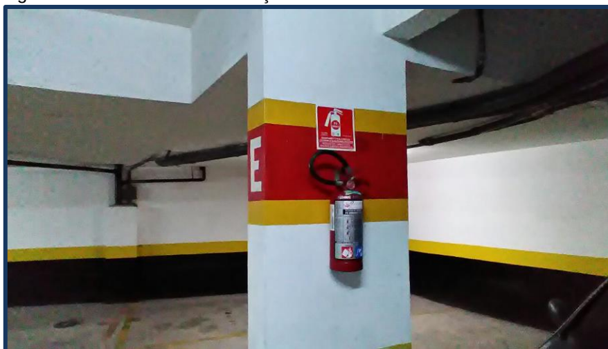
Figura 31 - Detalhe das sinalizações dos extintores nos subsolos.
