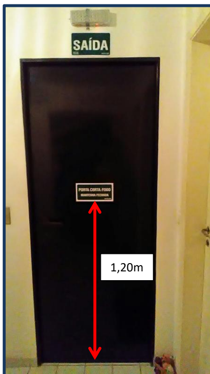
Figura 25 – Detalhe da instalação da sinalização de saída de emergência.
