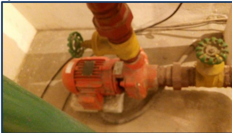
Figura 40 – Bomba de incêndio.
