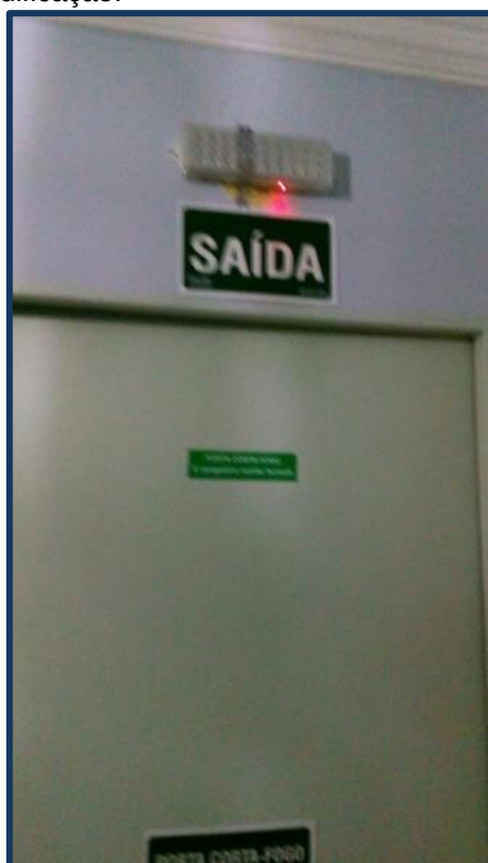
Figura 24 – Detalhe das luminárias presentes nos halls de cada um dos pavimentos da edificação.
