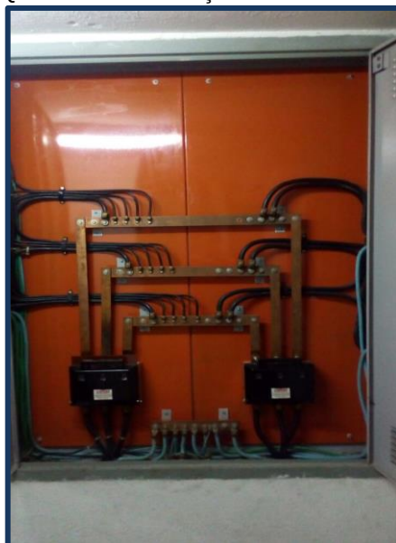
Figura 34 – Quadro de distribuição do condomínio.
