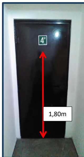
Figura 26 – Detalhe da instalação da sinalização nas portas de saída de emergência.
