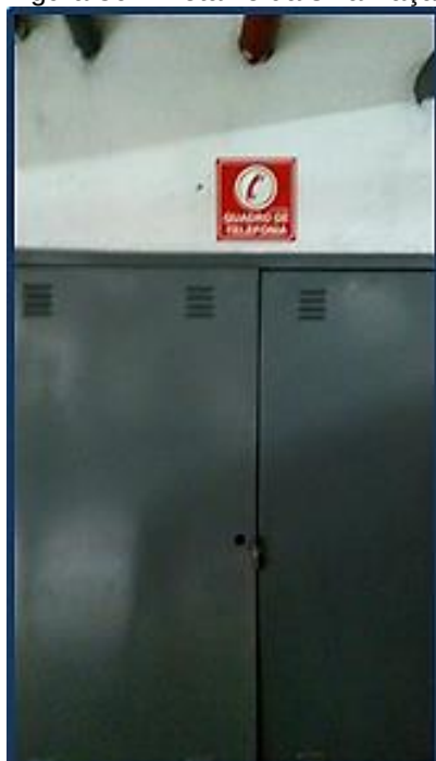
Figura 36 – Detalhe da sinalização do quadro de telefonia.
