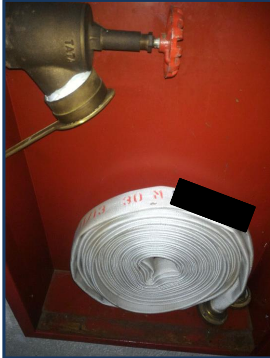
Figura 39 – Detalhe dos hidrantes dos subsolos – com o abrigo aberto.
