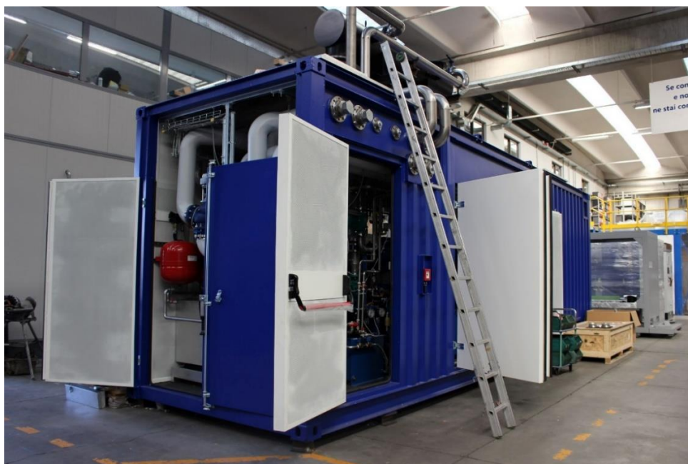
Figura 43 – Unidade de cogeração de gás natural
