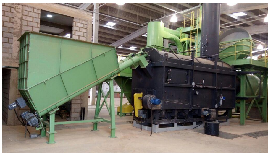
Figura 34 – Queimador à Biomassa
