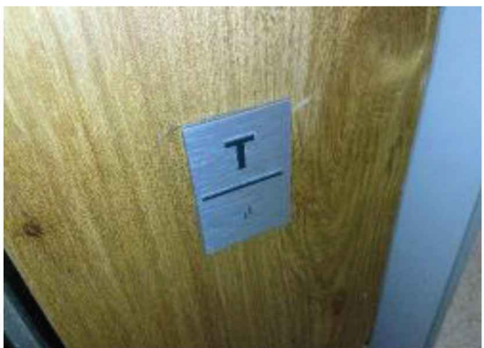
Foto 7 - Sinalização tátil para portas de elevadores, com identificação do local a ser acessado.
