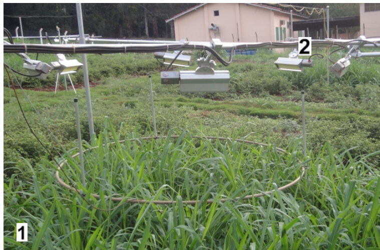
Figura 9. Aquecedores infravermelho de cerâmica instalados nas parcelas sob tratamento de aquecimento (+2°C). (1) Visão geral da parcela e da estrutura triangular que suporta os seis refletores que contêm os aquecedores de cerâmica, (2) Aquecedor no interior do refletor.
