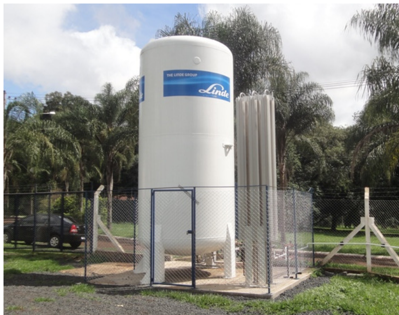
Figura 4. Tanque de CO 2 com capacidade para 12 toneladas e sua unidade vaporizadora, a direita.
