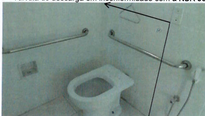
Figura 7 - Válvula de descarga em inconformidade com a NBR 9050/2015
