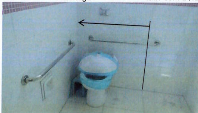
Figura 6 - Válvula de descarga em inconformidade com a NBR 9050/2015
