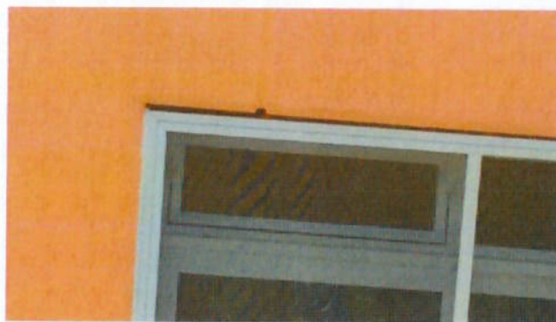
Figura 9 – Junção de vigas com espaçamento entre si, podendo haver infiltração (próximo a caixilhos). Vista externa
