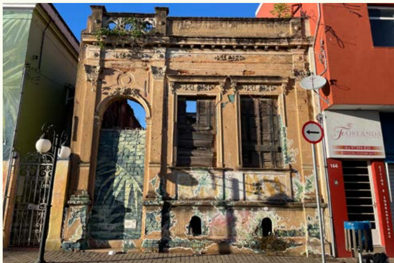
Figura 40: Fachada em ruínas. Autoria própria. 2025.
