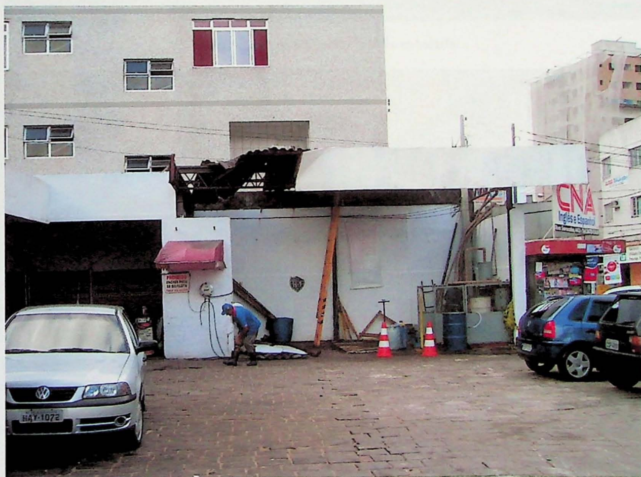
Foto 7.2: Vista geral do sistema instalado na área.
