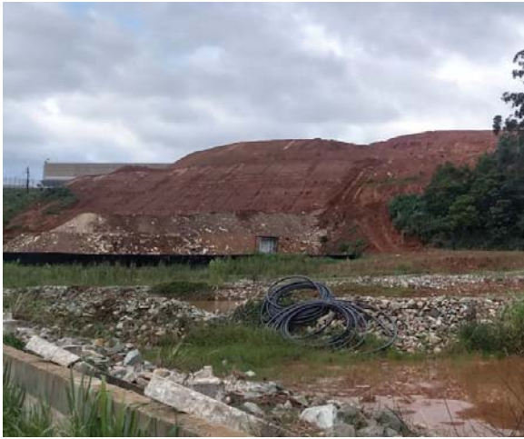
Figura 16 - Visão à montante da vila: obra de terraplanagem da empresa Marabraz, localizada no limite norte do bairro Gato Preto (fonte: Mayara Bispo, 2022)
