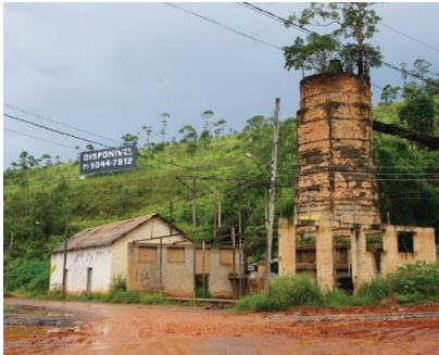
Figura 9 - Forno de alvenaria desativado, degradado e exposto às intempéries (fonte: Douglas Nascimento, 2013)
