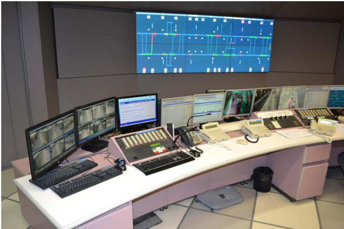
Figura 4 - Console de Controle de Fluxo de Passageiros da Linha 2
