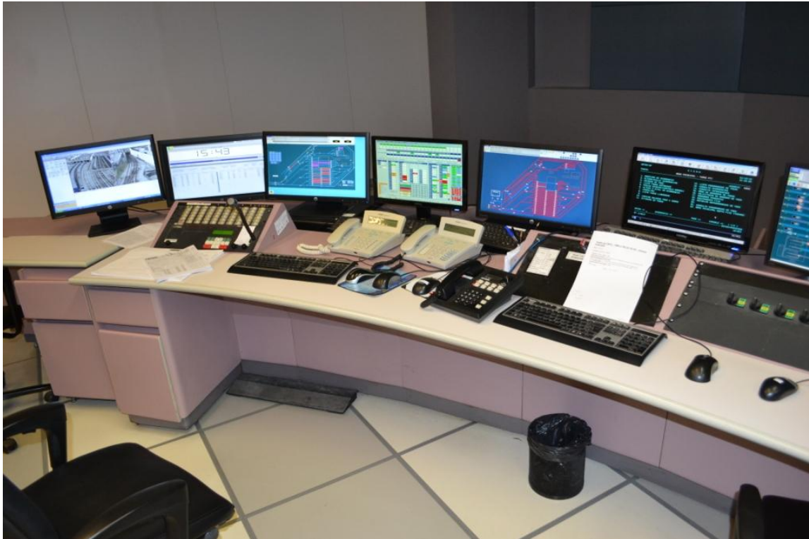
Figura 6 - Console de Controle do Pátio Jabaquara
