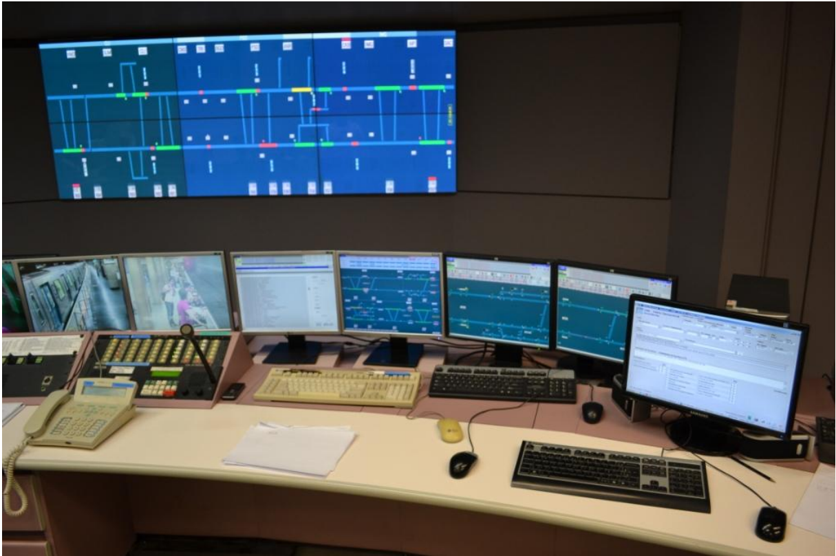
Figura 3 - Console de Controle de Tráfego da Linha 2
