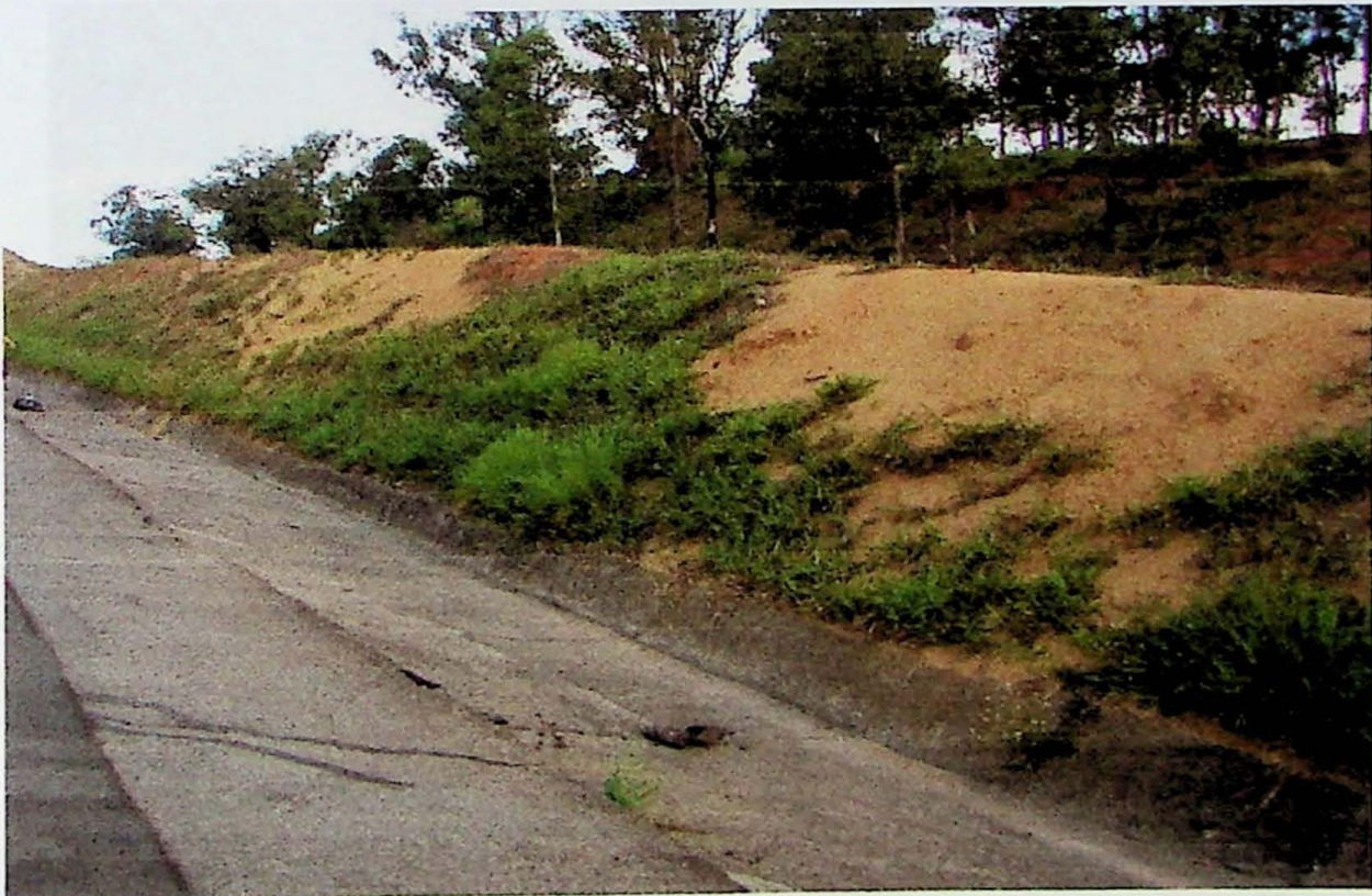
Foto 39-02 Vista geral, afloramento de folhelho alterado.
