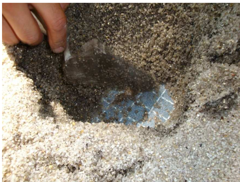
Figura 11 - Detalhe da sujeira abaixo da camada de interface com o ambiente.
