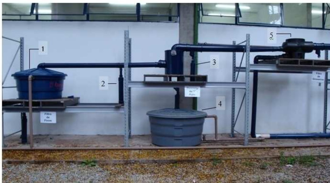
Figura 5 - Sistema de aproveitamento da água da chuva instalado no IPT (1 – filtro de areia; 2 e 3 – reservatórios de coleta; 4 – reservatório de descarte; e 5 – filtro de material grosseiro).
