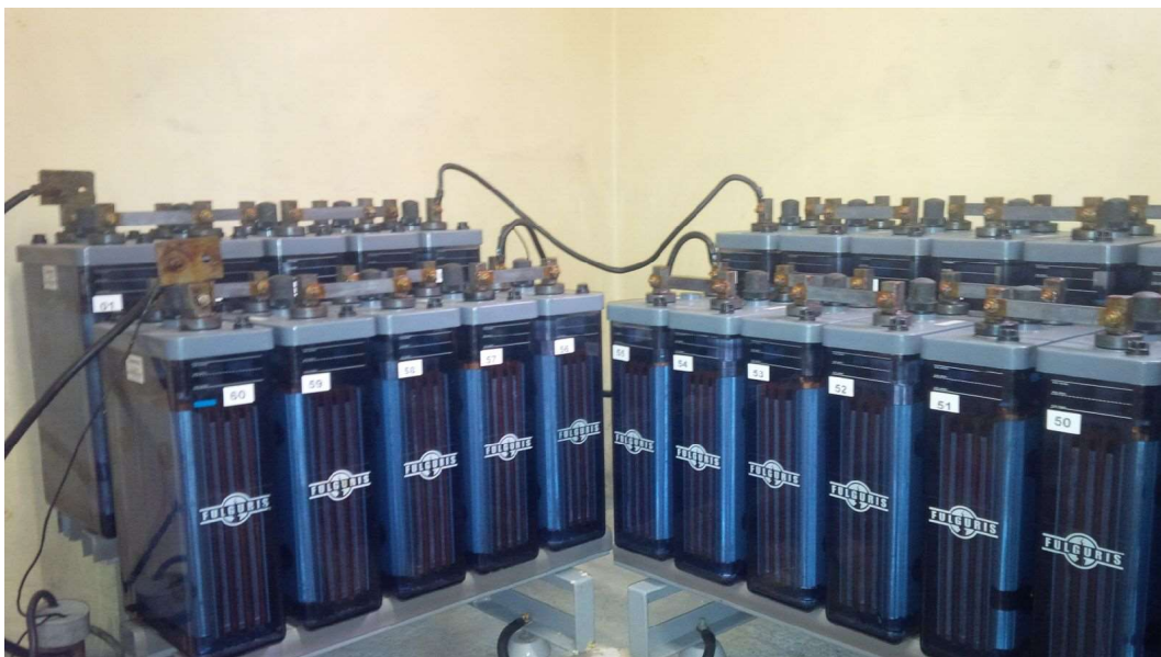
Figura 9 - Banco de Baterias.
