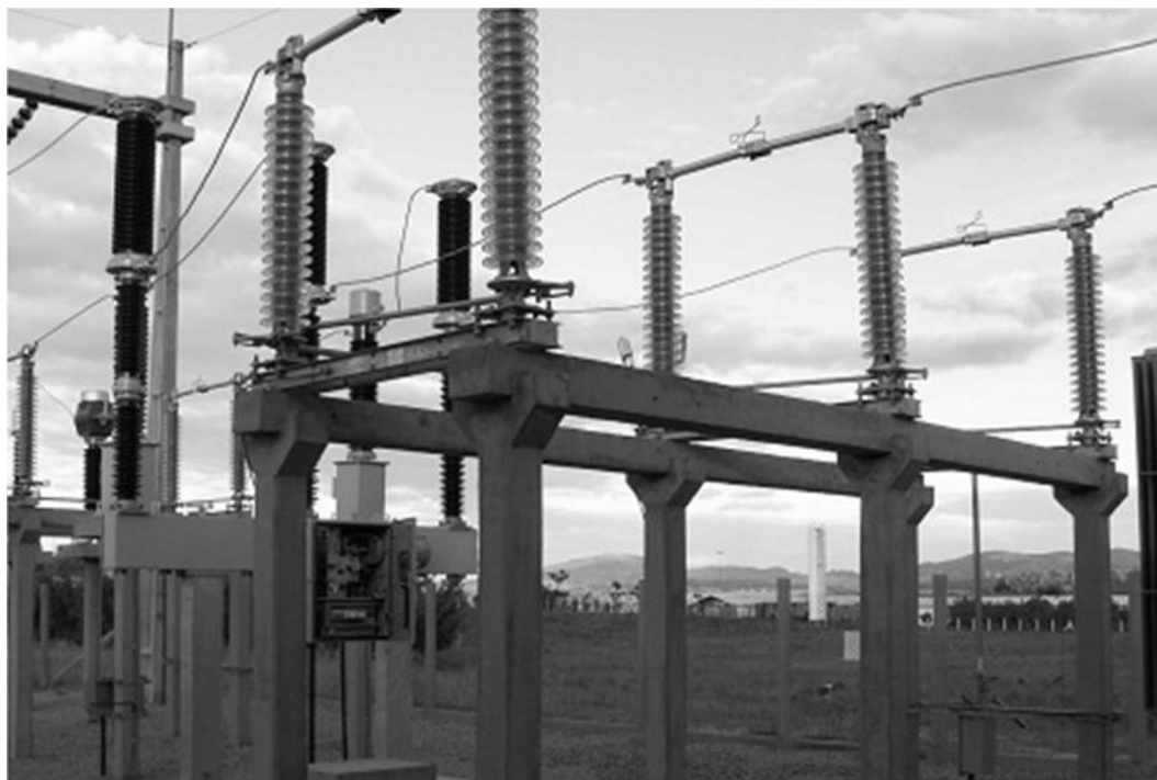
Figura 22 – Chave Comutadora de Alta Tensão. (RAIELECTRICA)
