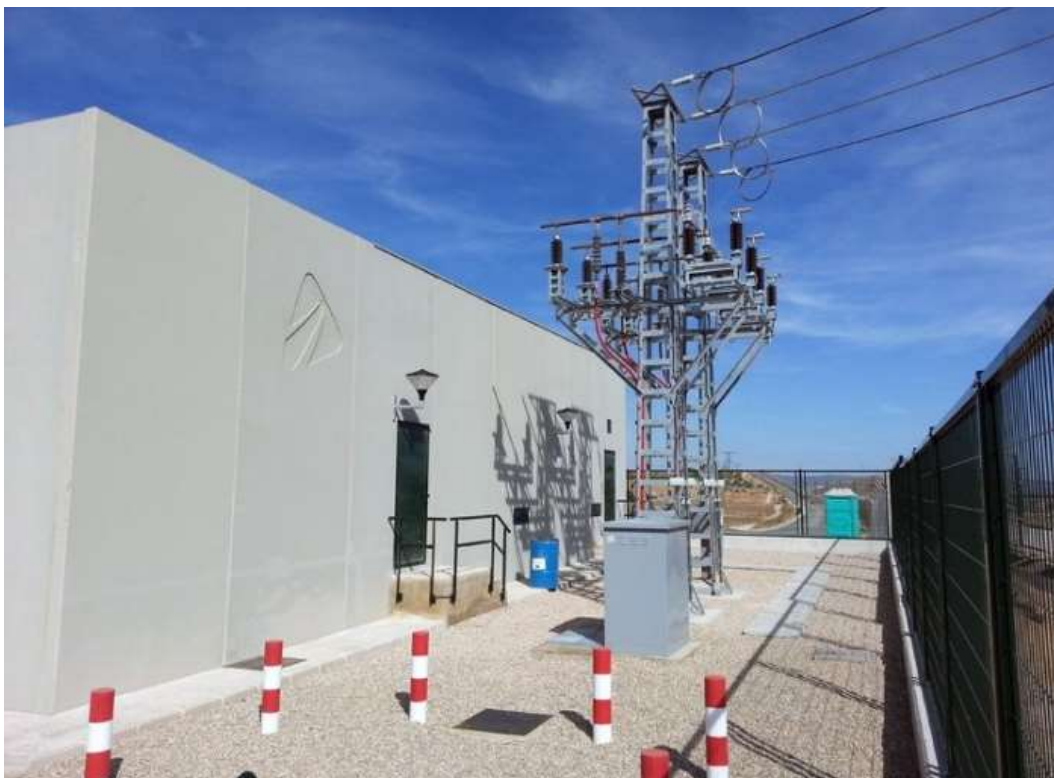
Figura 25 - Chave seccionadora de saída da subestação para a rede aérea de tração. (MARINO, 2015)
