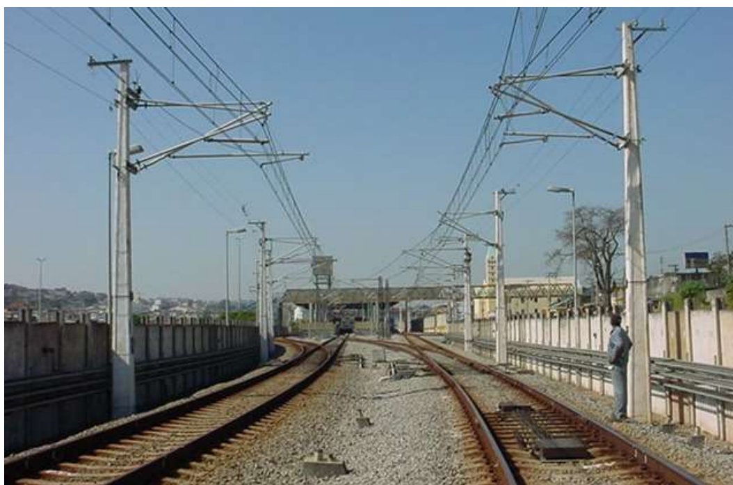
Figura 27 - Rede aérea de tração autocompensada em 3 kVcc.
