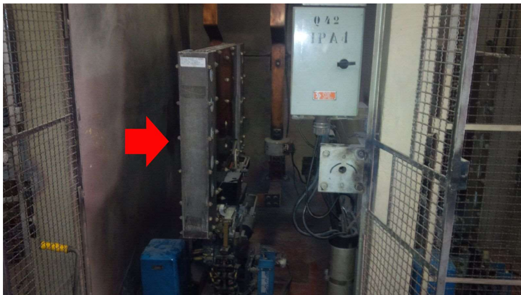
Figura 7 - Disjuntor de Proteção – 3 kVcc.
