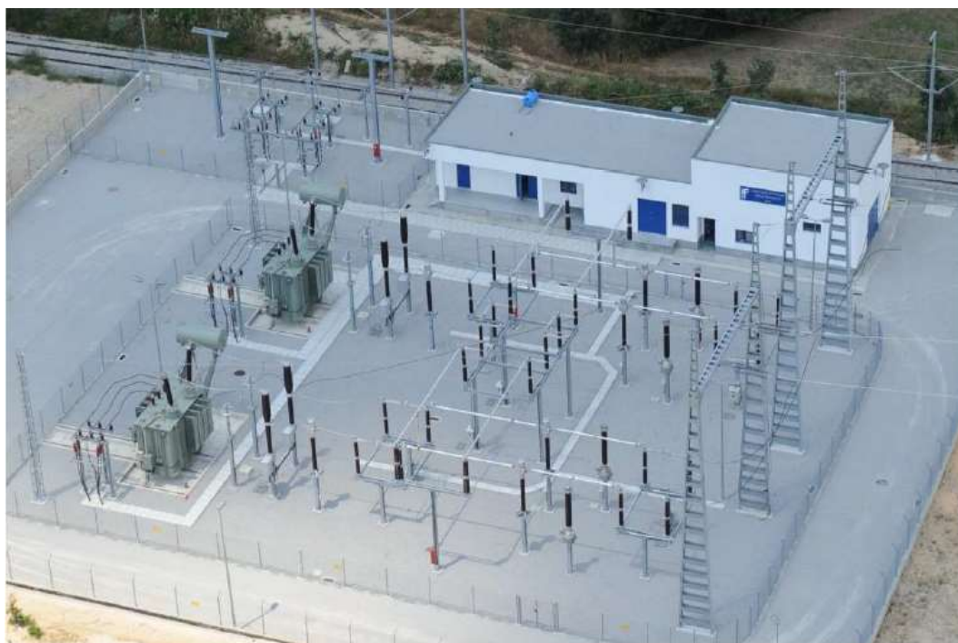
Figura 14 - Subestação rebaixadora em 25 kVca. (FOLGADO, 2015)
