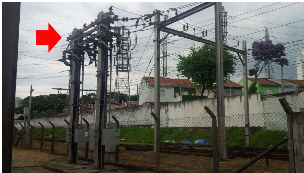
Figura 8 - Chaves seccionadora de saída de linha para 3 kVcc.
