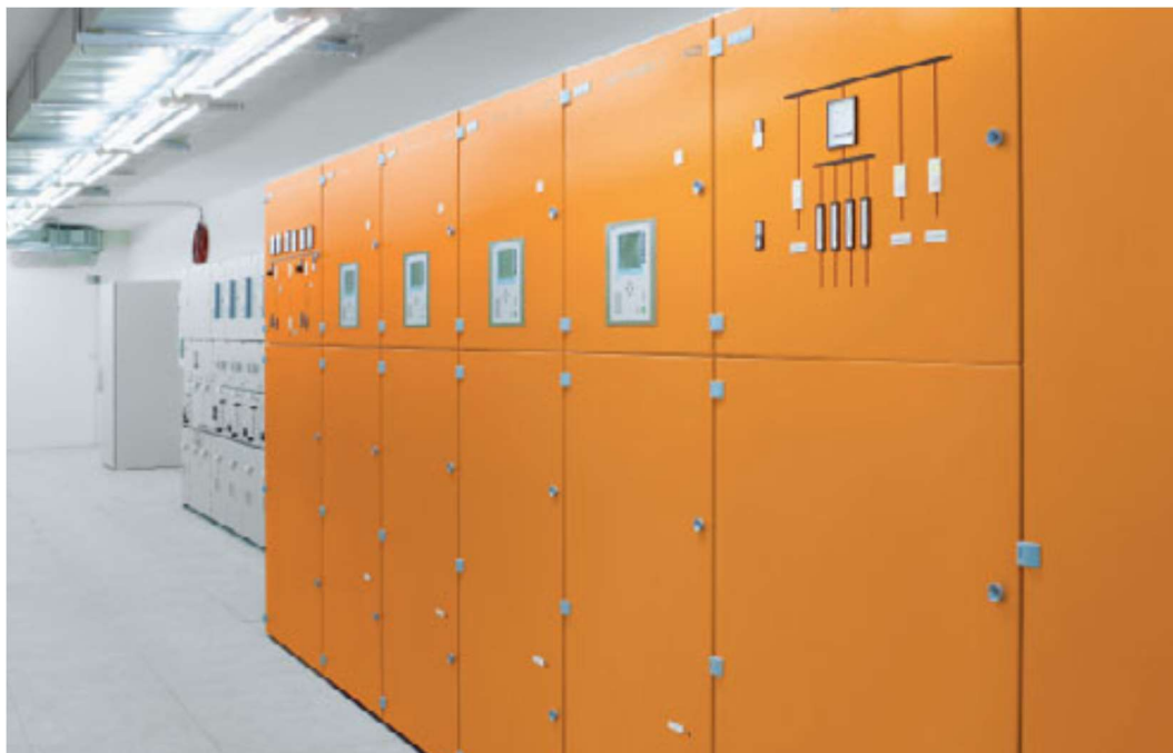
Figura 24 - Painel de comando da subestação de tração. (SIEMENS)
