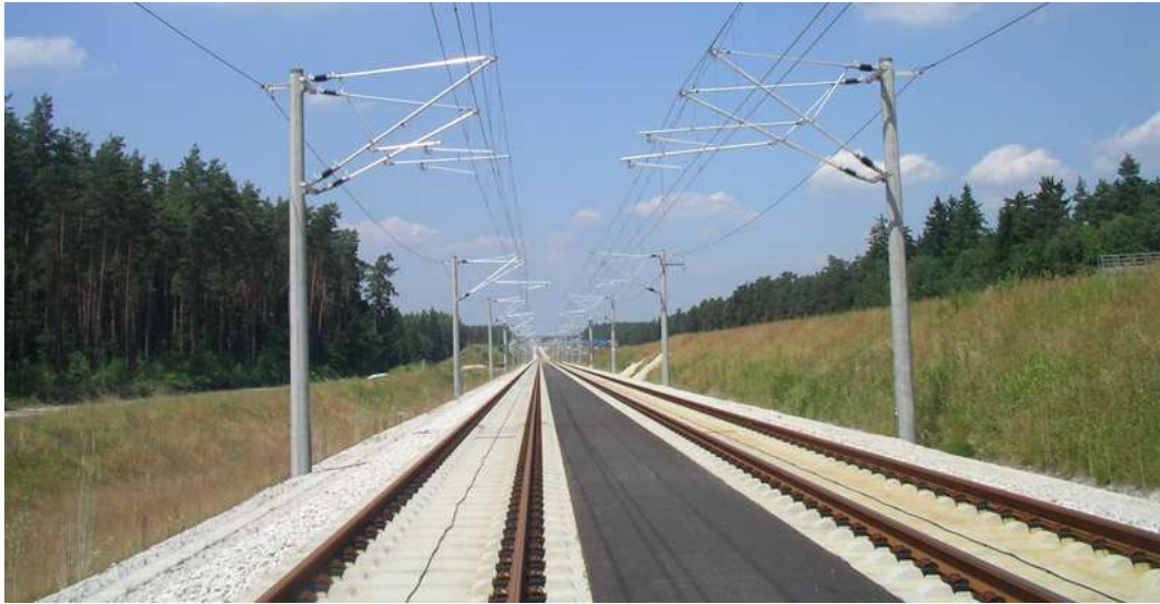
Figura 28 - Rede aérea de tração autocompensada em 1x25 kVca.
