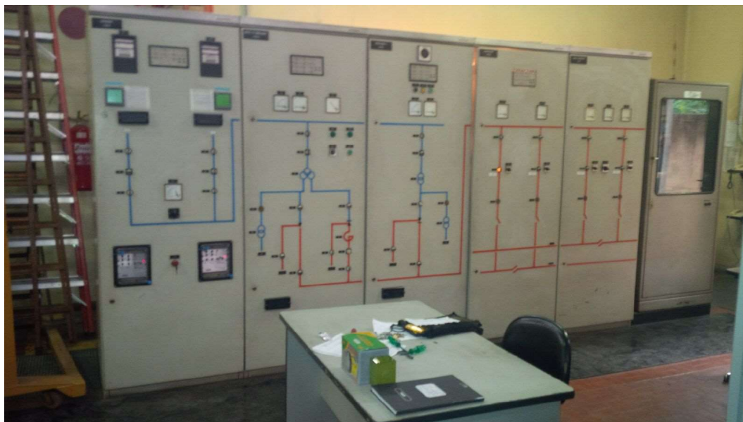
Figura 12 - Painel de Comando.
