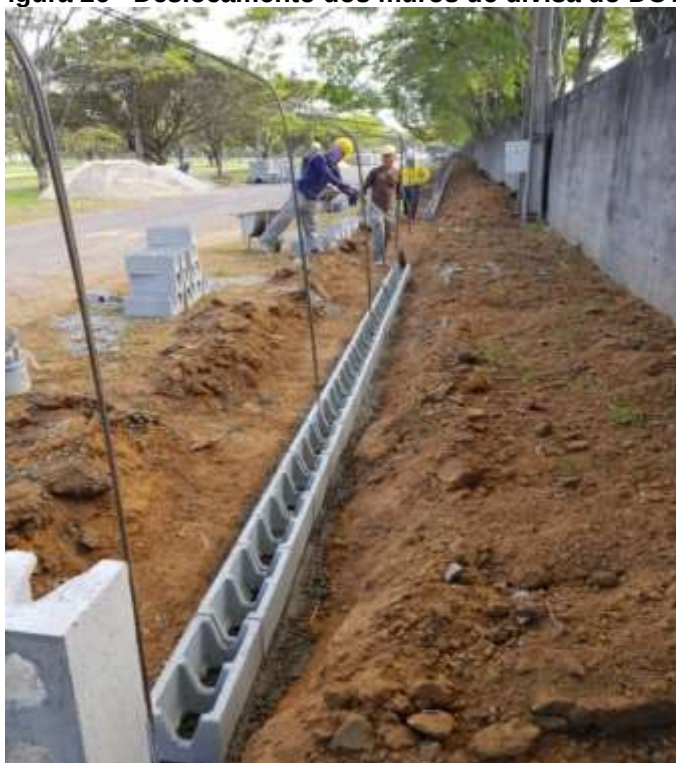
Figura 26 - Deslocamento dos muros de divisa do DCTA
