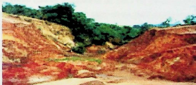
Foto 2 – Aspecto da Boçoroca do São Dimas, São Pedro, SP, ( http://www.ipt.br/areas/digeo/srg ).
