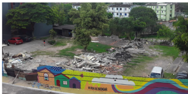
Figura 18: Sequência de fotografias da demolição das garagens do terreno na ocasião da execução da reintegração de posse.
