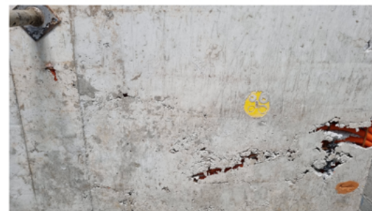
Figura 44: Montagem de fotos - falhas executivas nas lajes.
