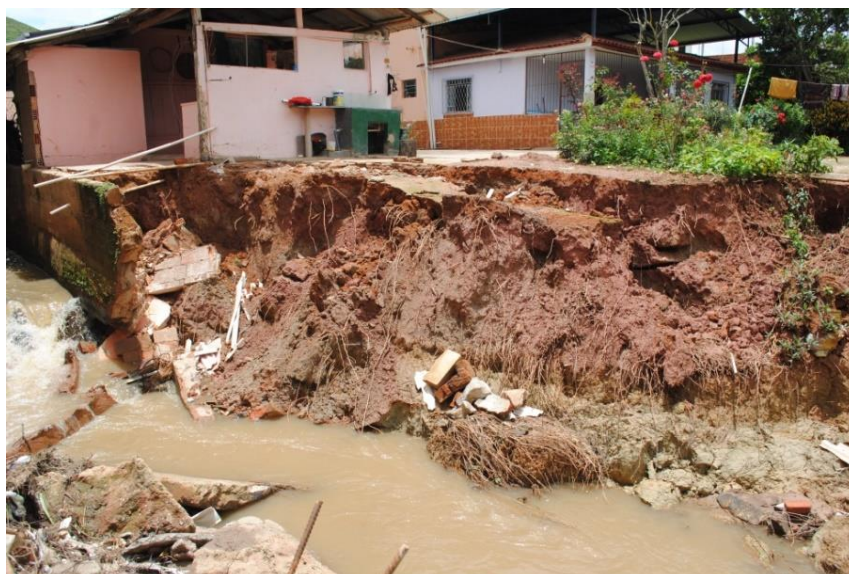
Figura 4.3.4 – Efeitos das chuvas fortes nas residências localizadas em áreas vulneráveis.
