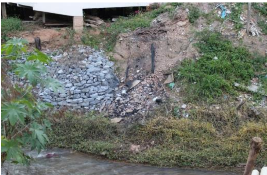
Figura 4.3.3 – Muros de contenção construídos pelos moradores nas regiões das encostas do Rio Pardo para conter os efeitos da dragagem.
