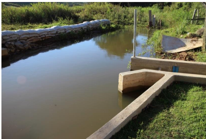
Figura 4.1.6 - Ponto de captação de água bruta.
