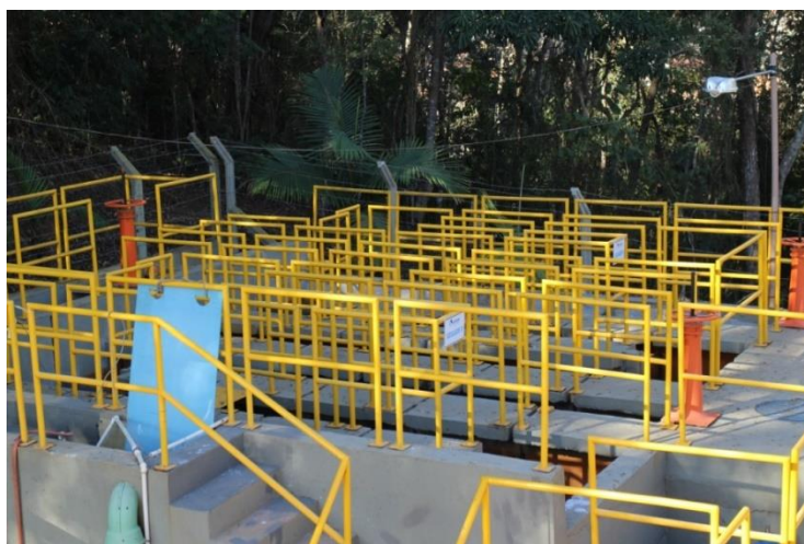
Figura 4.1.5 – Unidade de floculação da ETA.
