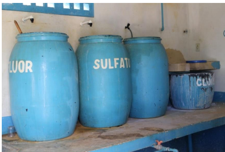
Figura 4.1.2 - Acondicionamento dos produtos químicos da ETA da zona rural.
