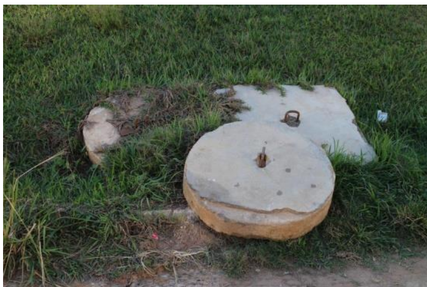
Figura 4.3.2 - Condição do bueiros encontrados.
