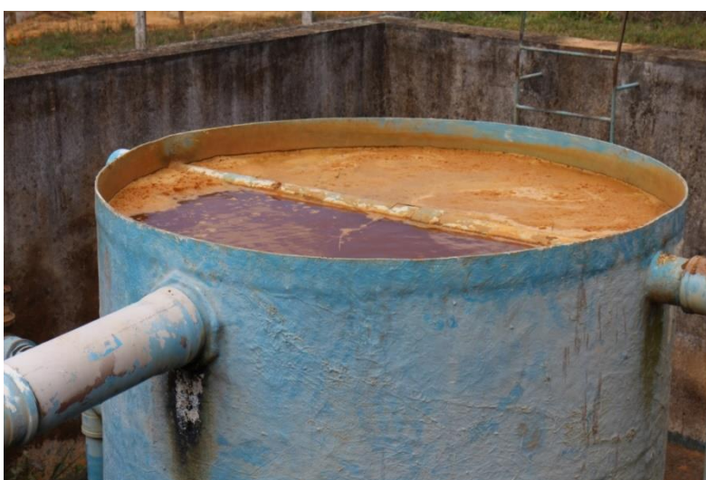
Figura 4.1.3 – Unidade de filtração da ETA da zona rural.
