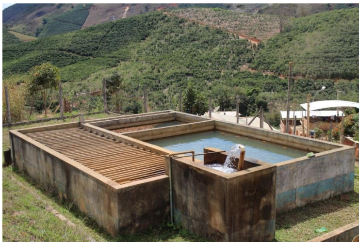
Figura 4.1.1 – Unidade de mistura rápida, flocculador e decantador componentes da ETA da zona rural.
