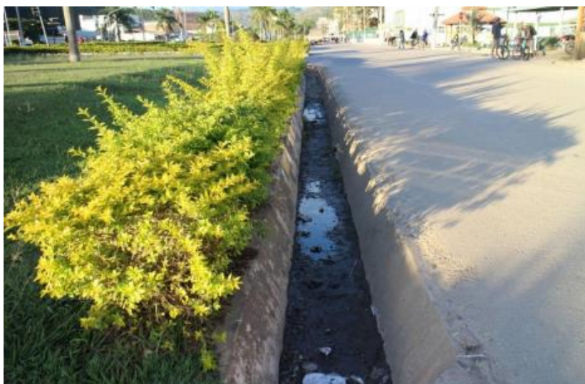
Figura 4.3.1 - Rede pluvial como local de disposição inadequada de resíduos e esgoto sanitário.
