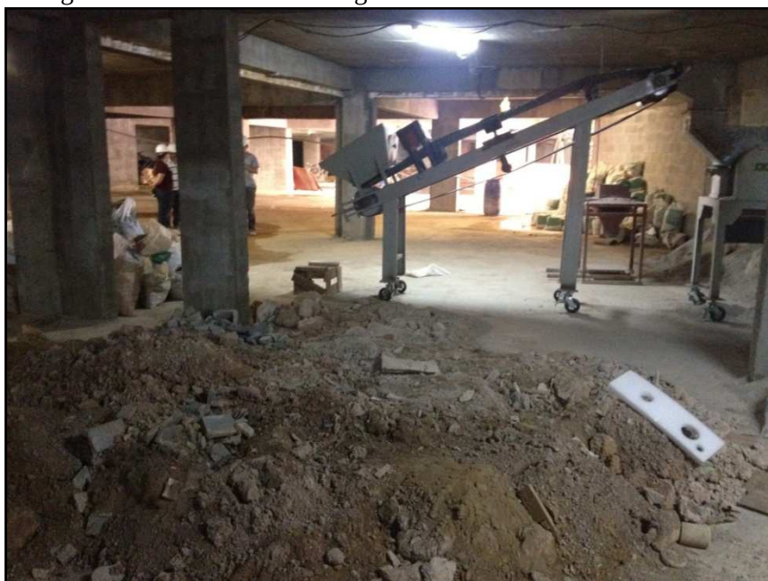
Fotografia 11: Central de reciclagem instalada na obra.
