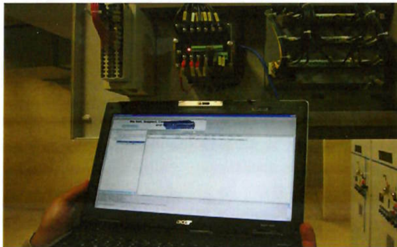
Figura 24 – Monitoração do medidor eletrônico via Ethernet e serial
