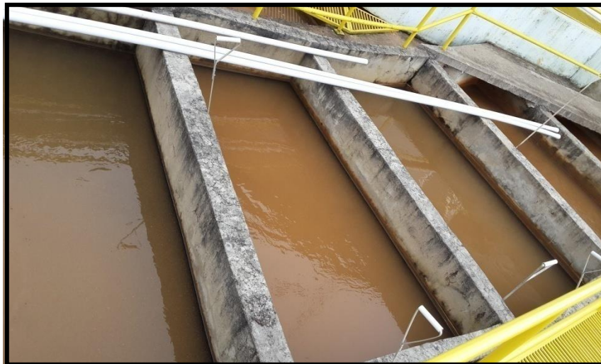
Figura 16 – Tanques de floculação da ETA municipal
