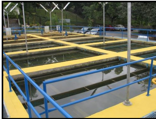
Figura 10 – Tanques de decantação de uma ETA
