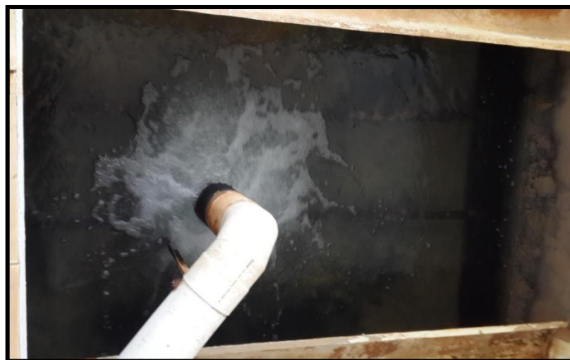
Figura 18 – Filtro rápido de fluxo descendente da ETA municipal
