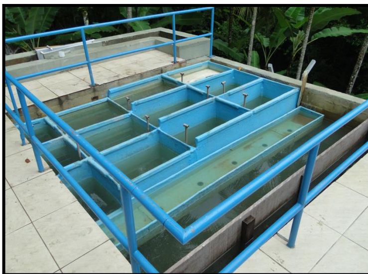
Figura 9 – Tanques de floculação de uma ETA
