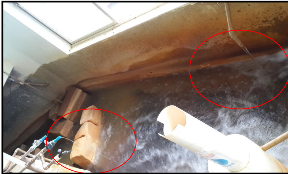
Figura 15 – Adição de Policloreto e Alumínio e Hipoclorito de Sódio
