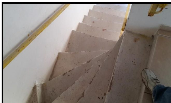
Figura 31 – Escada mal projetada
