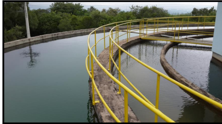
Figura 17 – Tanques de decantação da ETA municipal
