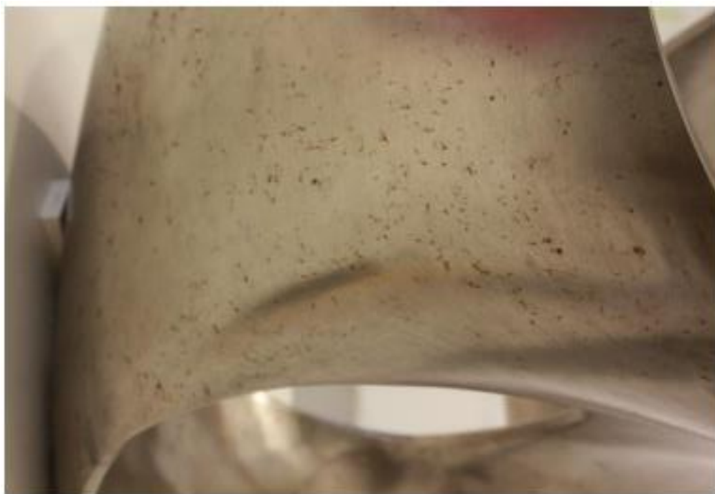
Figura 10 - Pontos vermelhos de corrosão. Fonte: (BONGIORNO; PICCARDO, 2013).
