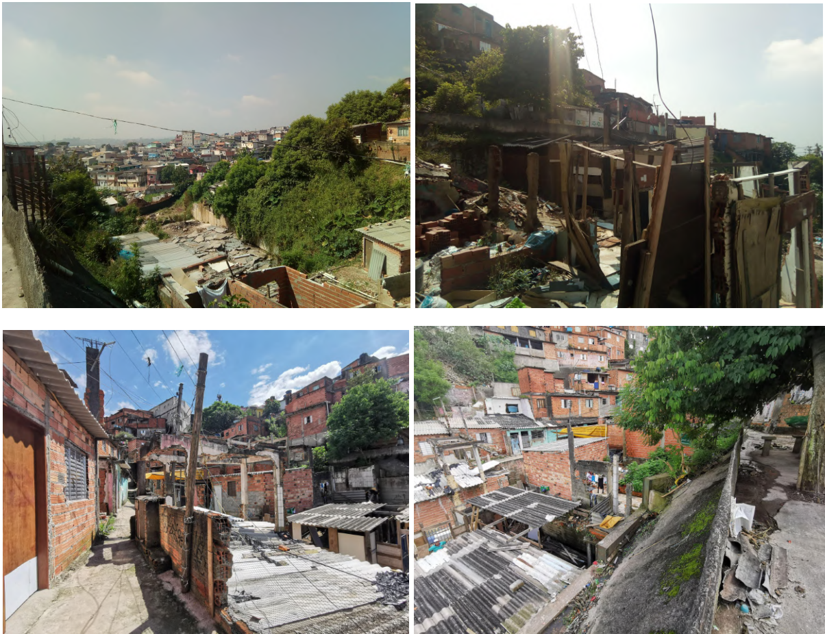
Figura 9. Ocupações de alvenaria e madeira ao longo do talvegue, em meio a excesso de entulho e lixo (sup., 2019). Casas e barracos ao longo da Vela Gabiroba (inf. esq.) e contenção da encosta de pequeno porte, com presença de trincas e rachaduras (inf. dir.). Março de 2021. Fonte: COMDEC.
