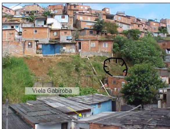
Figura 8. Moradias de alvenaria e madeira em trecho próximo à Viela Gabiroba, com cicatriz de escorregamento. Fonte: FUSP (2003)
