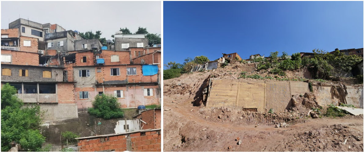
Figura 11. Visualização de um mesmo talude nos meses de fevereiro de 2024 (esq.) e agosto do mesmo ano (dir.). Com a remoção das moradias (antiga Viela Gabiroba), foi possível se aproximar da face do talude. Notar a presença de algumas moradias reliquiarias na crista do talude da imagem a direita.
