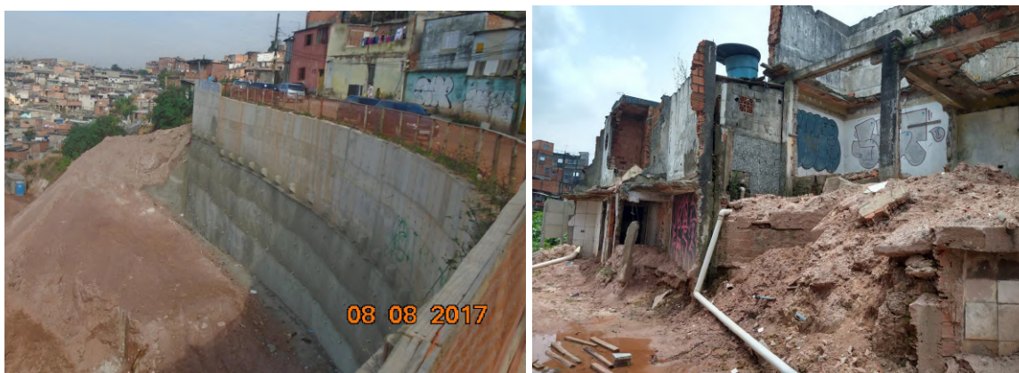
Figura 24. Cortina atirantada na encosta da Rua da União em 2017 (esq.). Estruturas reliquias de casas destruídas próximas à Rua da União, em dezembro de 2021 (dir.), notar concentração de água no aterro misturado a solo residual. Fonte: COMDEC.
