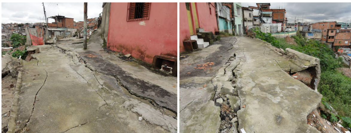
Figura 23. Pavimento trincado na Rua da União. Fonte: COMDEC, 2015.
