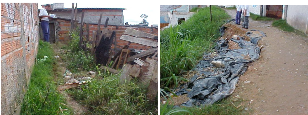
Figura 21. Trecho próximo à Vuela União com ocupações de alvenaria e estacas de madeira. Notar movimentação do solo (dir.). Fonte: FUSP, 2003.
