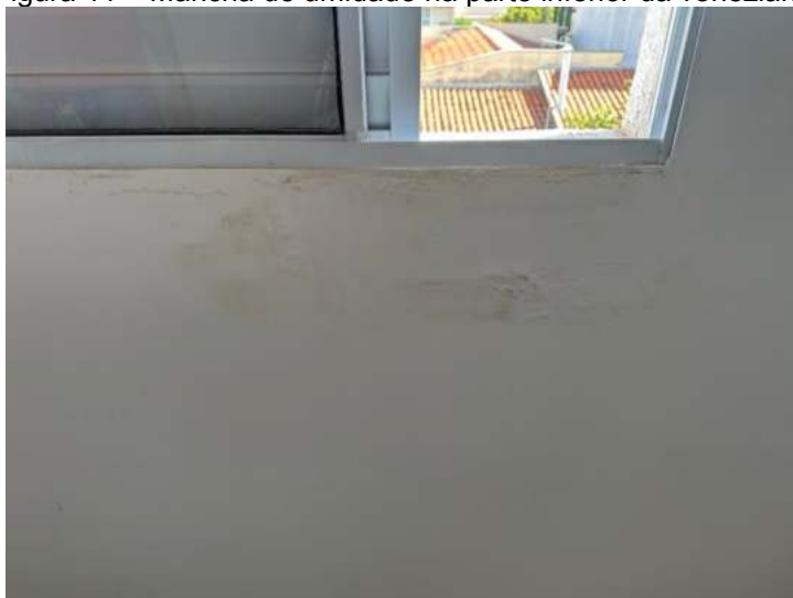
Figura 11 – Mancha de umidade na parte inferior da veneziana
