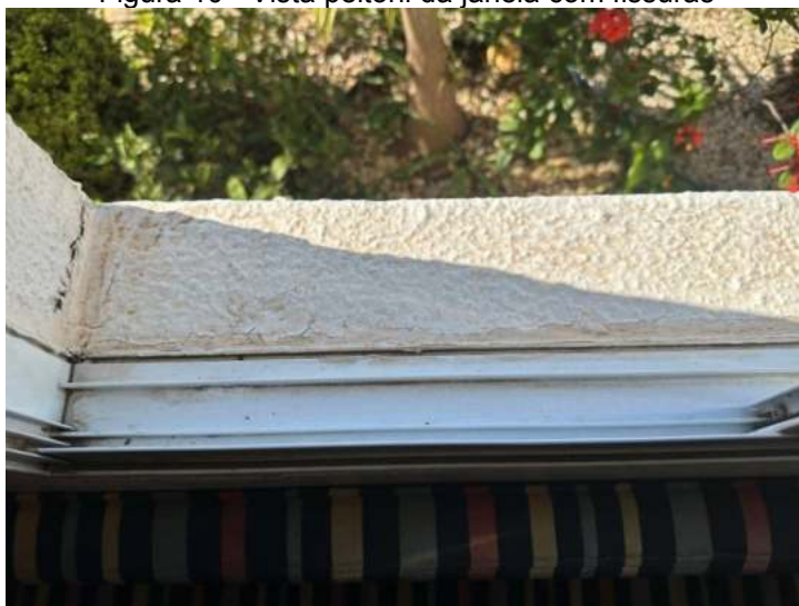
Figura 10 - Vista peitoril da janela com fissuras
