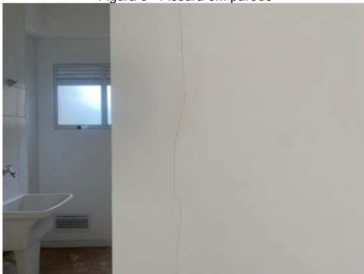
Figura 3 - Fissura em parede
