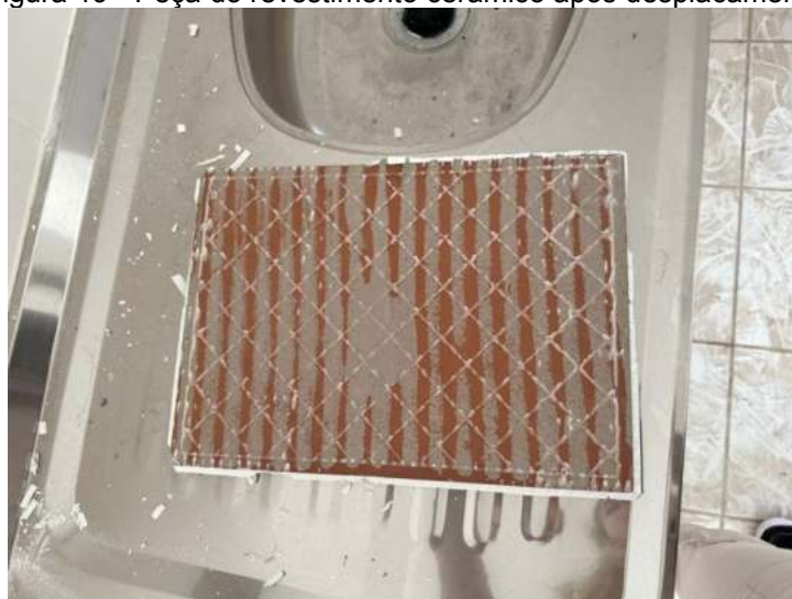
Figura 19 - Peça do revestimento cerâmico após deslocamento
