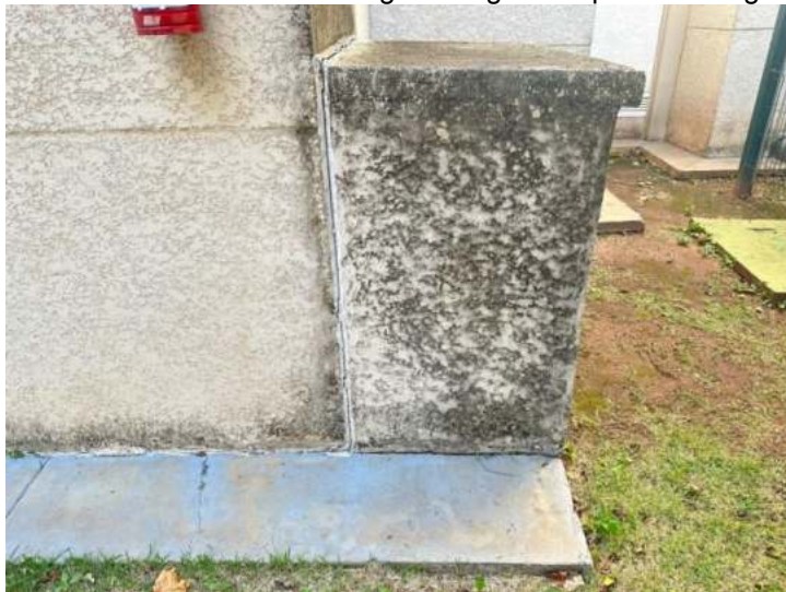
Figura 28 – Trinca entre alvenaria e abrigo de regulador pressão do gás canalizado
