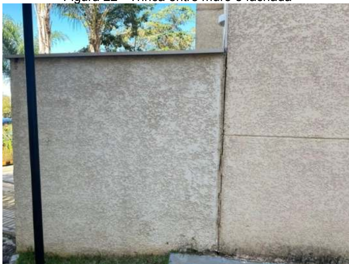
Figura 22 - Trinca entre muro e fachada
