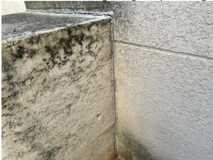
Figura 29 – Trinca entre alvenaria e abrigo de regulador pressão do gás canalizado
