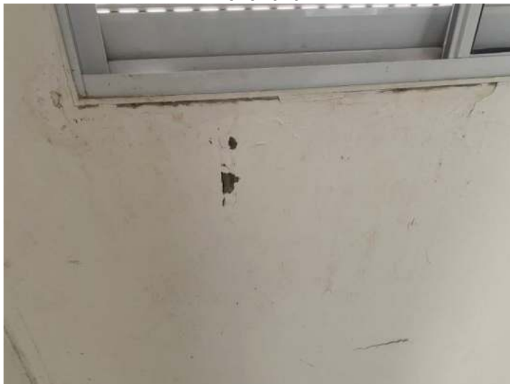
Figura 13 – Mancha de umidade e descolamento de revestimento parte inferior e em canto da veneziana
