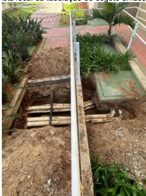
Figura 32 – Vista local da tubulação de esgoto amassada e rompida
