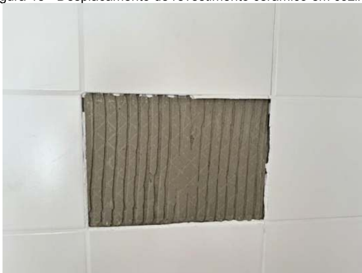
Figura 18 - Desplacamento de revestimento cerâmico em cozinha
