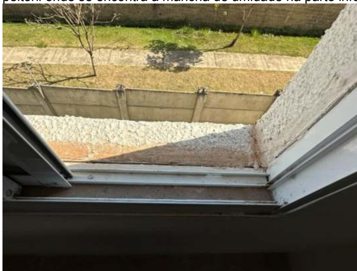
Figura 12 - Vista peitoril onde se encontra a mancha de umidade na parte inferior da veneziana
