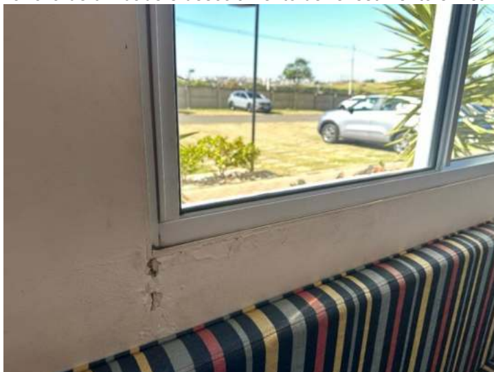
Figura 8 – Mancha de umidade e descolamento de revestimento em canto da janela
