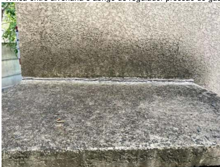
Figura 30 – Trinca entre alvenaria e abrigo de regulador pressão do gás canalizado
