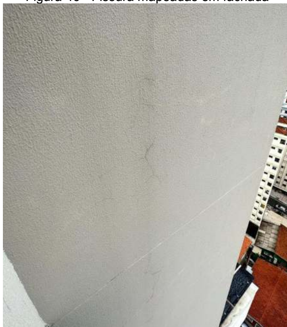
Figura 46 - Fissura mapeadas em fachada
