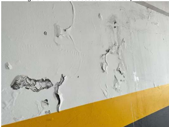
Figura 37 - Bolhas e descolamento da pintura
