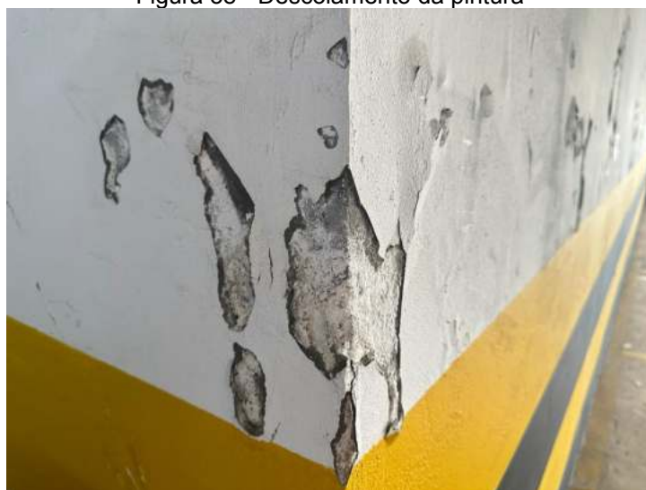
Figura 38 - Descolamento da pintura
