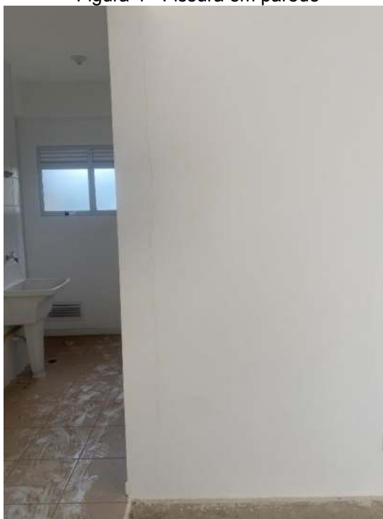
Figura 4 - Fissura em parede
