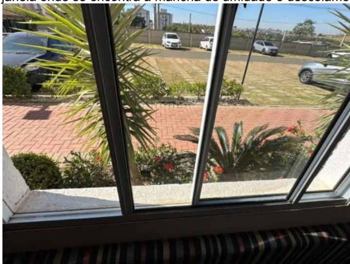
Figura 9 - Vista da janela onde se encontra a mancha de umidade e descolamento de revestimento
