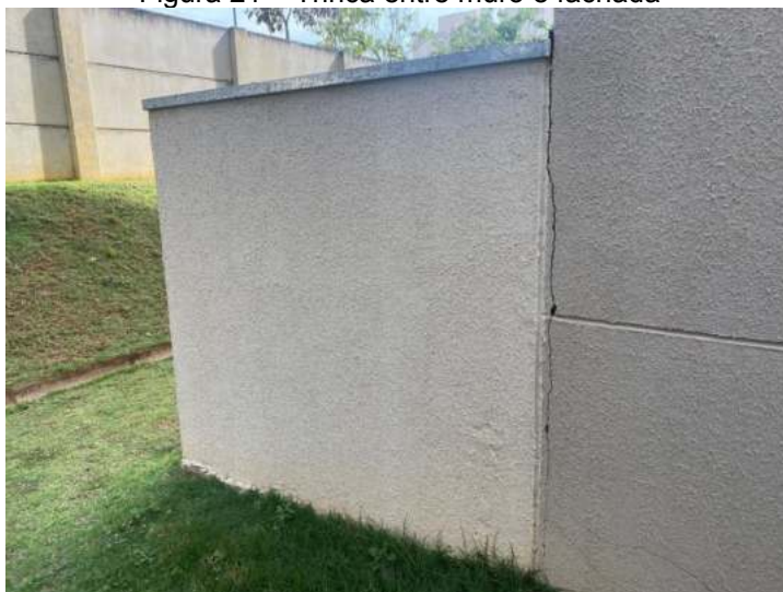
Figura 21 – Trinca entre muro e fachada
