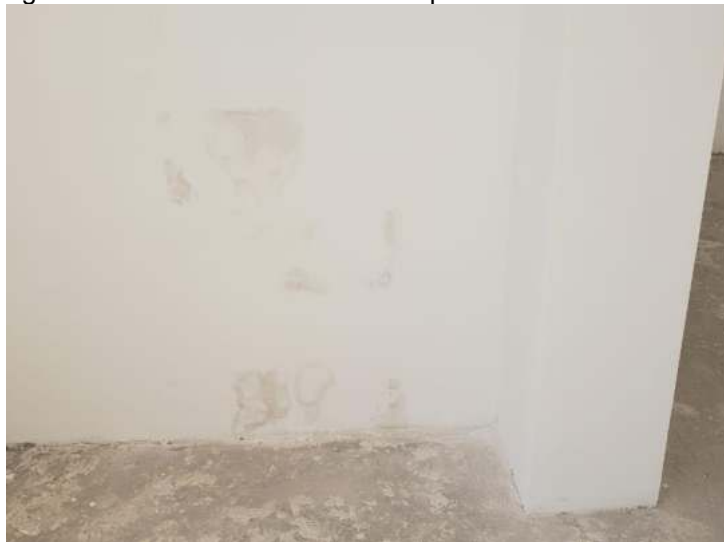
Figura 49 - Mancha de umidade em parede interna da fachada
