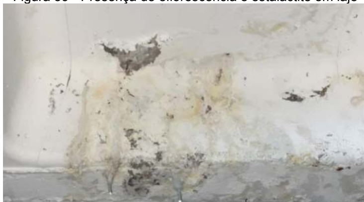
Figura 39 - Presença de eflorescência e estalactite em laje
