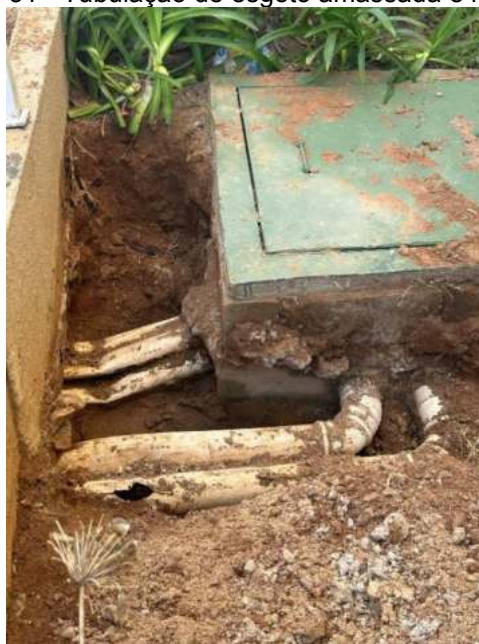
Figura 31 - Tubulação de esgoto amassada e rompida
