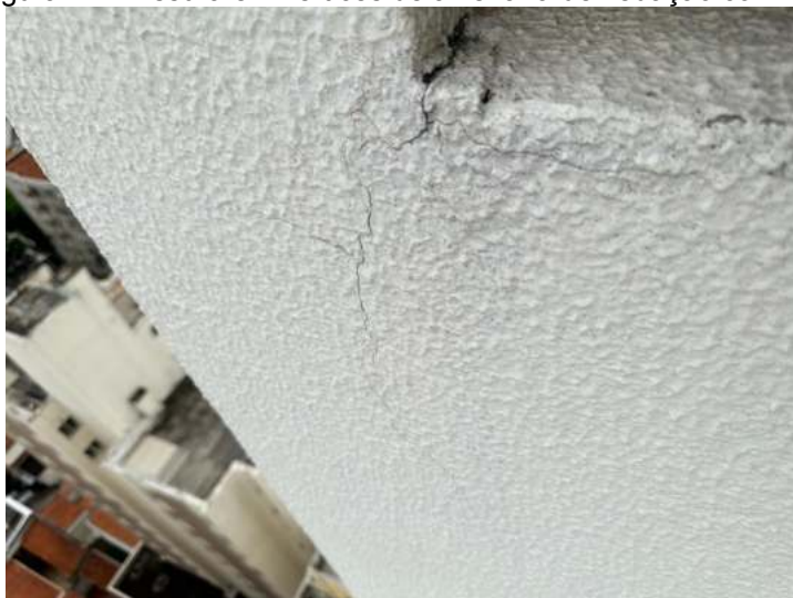
Figura 47 - Fissura em vértices de alvenaria de vedação com vão
