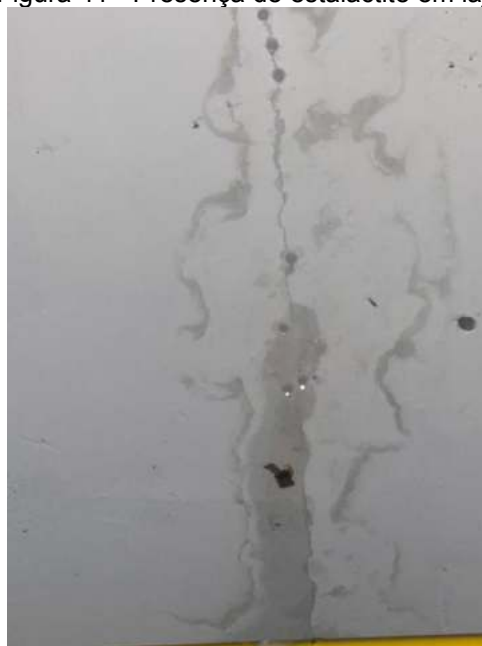
Figura 41 - Presença de estalactite em laje
