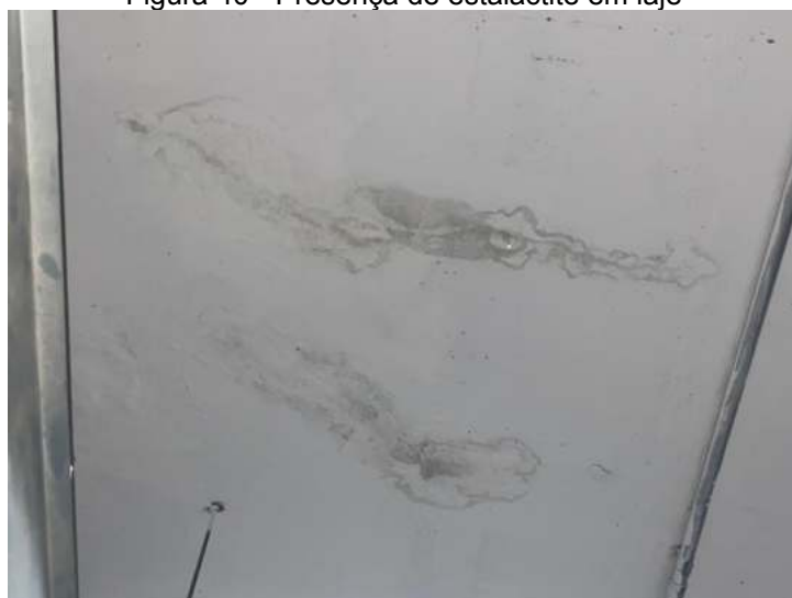
Figura 40 - Presença de estalactite em laje
