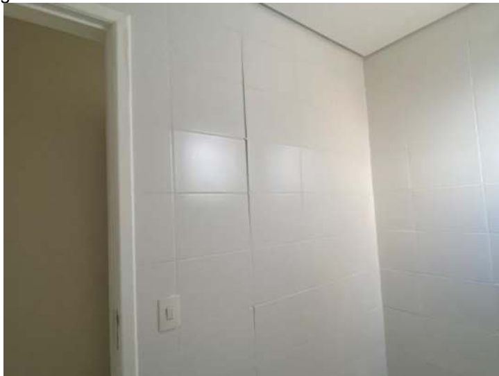
Figura 16 - Descolamento de revestimento cerâmico em banheiro
