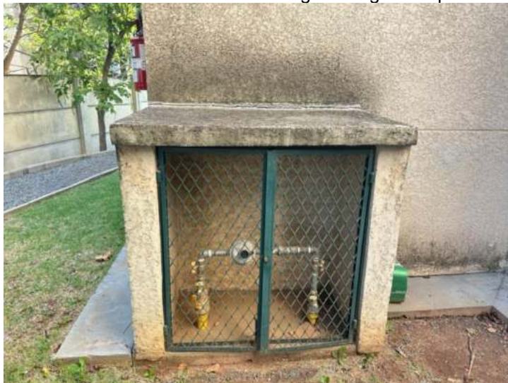
Figura 27 – Vista local da trinca entre alvenaria e abrigo de regulador pressão do gás canalizado
