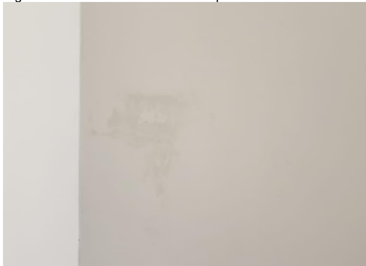
Figura 50 - Mancha de umidade em parede interna da fachada
