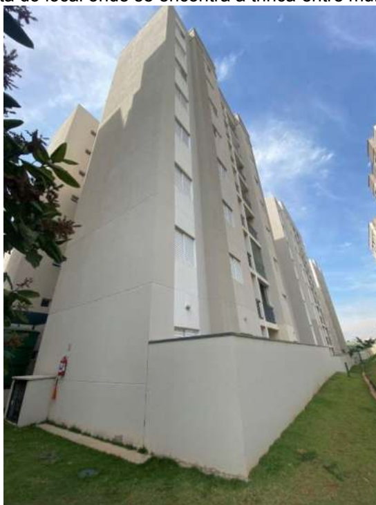
Figura 23 - Vista do local onde se encontra a trinca entre muro e fachada
