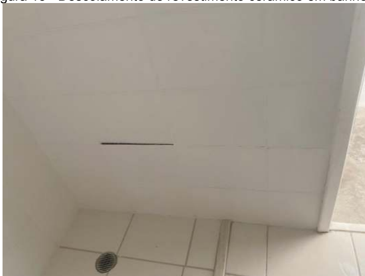
Figura 15 - Descolamento de revestimento cerâmico em banheiro
