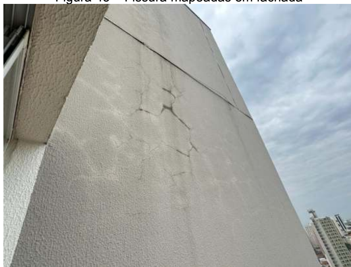
Figura 45 – Fissura mapeadas em fachada
