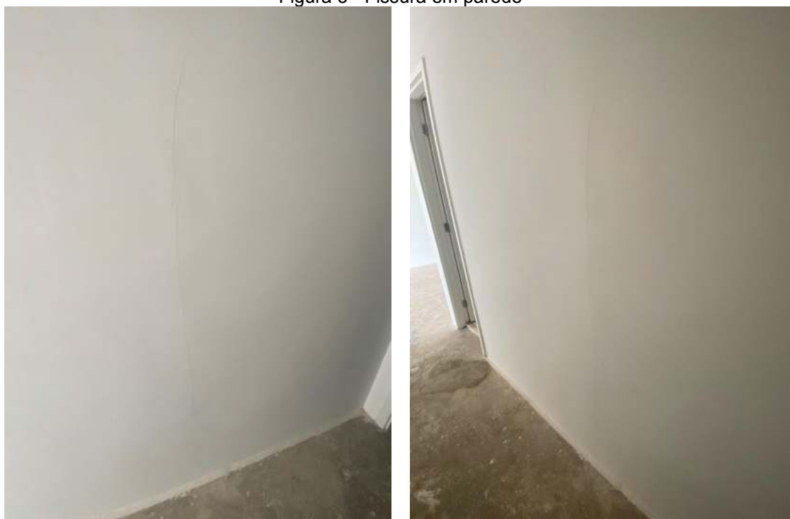
Figura 5 - Fissura em parede
