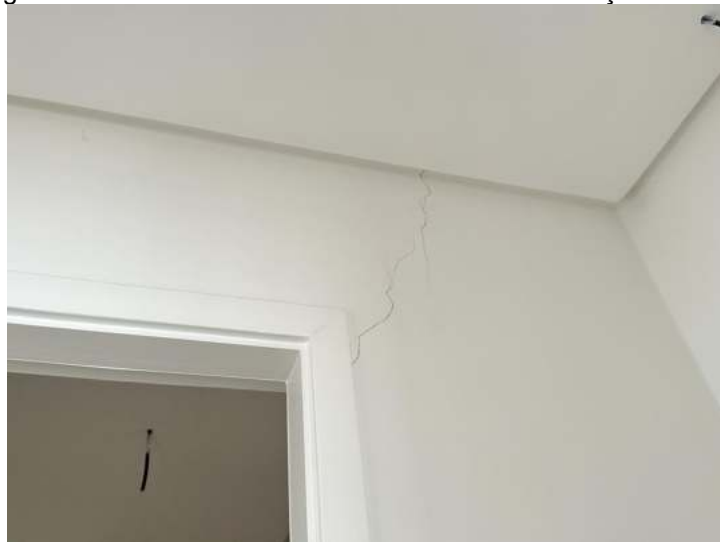
Figura 48 - Fissura em vértices de alvenaria de vedação com vão
