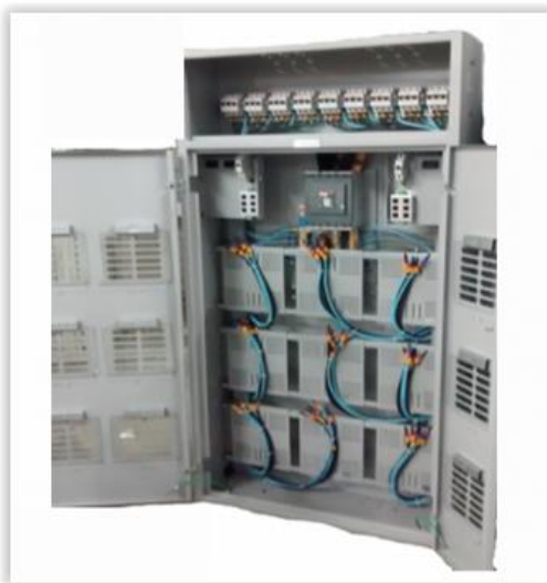
Figura 11 – Caixa de medição eletrônica descentralizada
