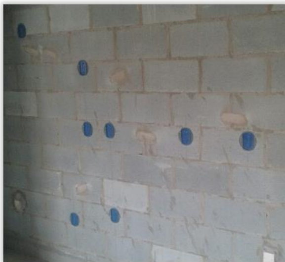
Figura 20 – Distribuição elétrica executada
