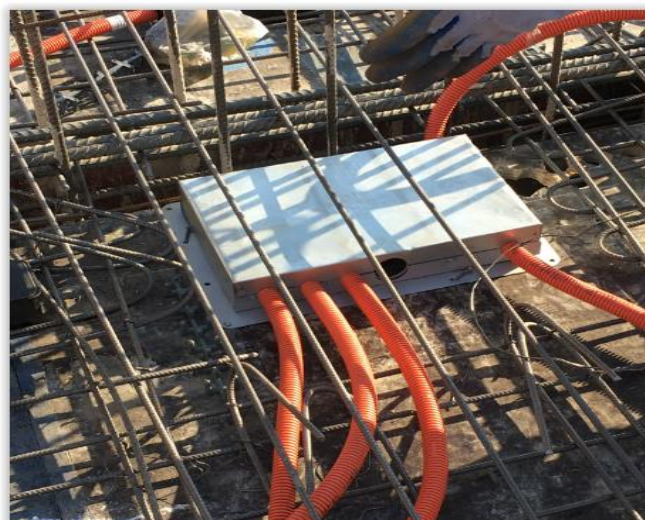
Figura 17 – Caixa central para quadro elétrico
