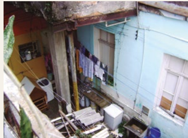
Vigas metálicas e um pilar sustentam a varanda inclinada. É possível ver tubulação indicando sistema hidráulico nessa parte.
