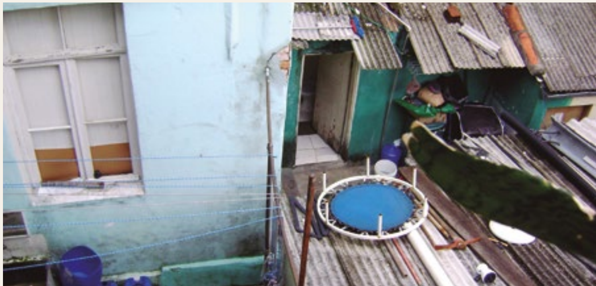
Banheiro que serve o edifício, entre a Casa 19 e outras acomodações construídas nos fundos.
