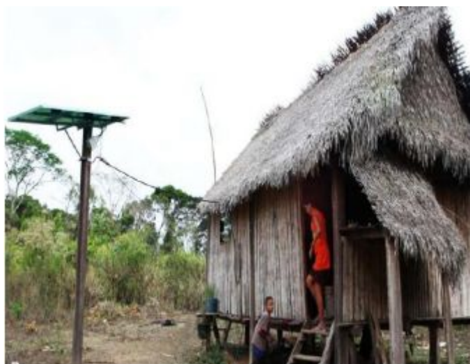
Figura 38: SIGFI instalado em Albrácea.
