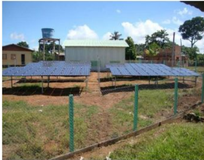
Figura 37: Mini-usina de Sobrado, no Amazonas.
