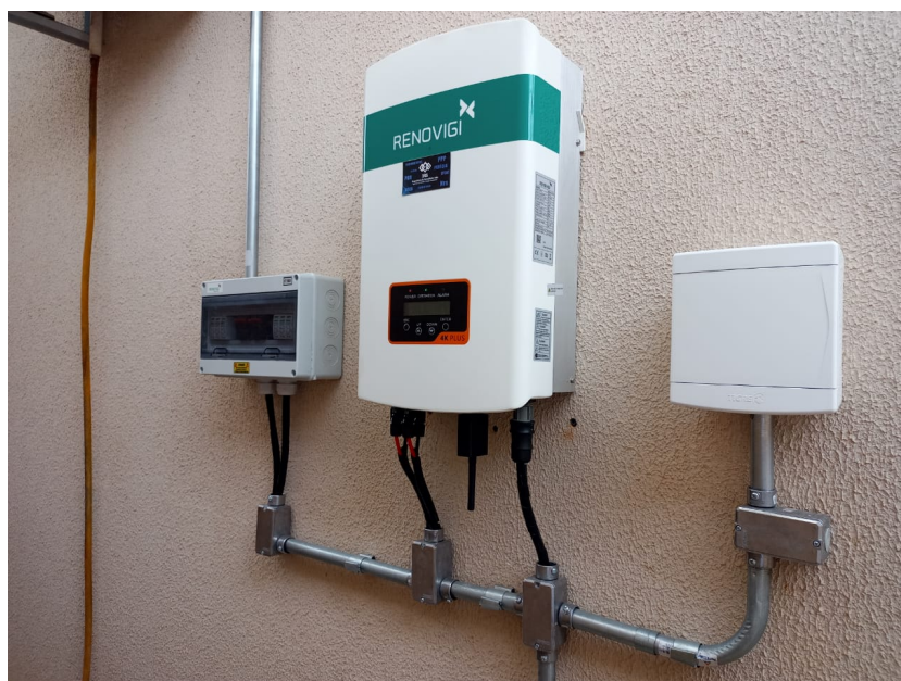
Figura 24: Inversor e dispositivos de proteção e seccionamento
