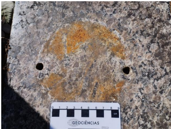
Figura 32: Perfuração e manchamento em túmulo de Granito Ocre Itabira.
