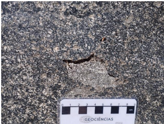
Figura 27: Esfoliação em túmulo de Granito Preto Piracaia.
