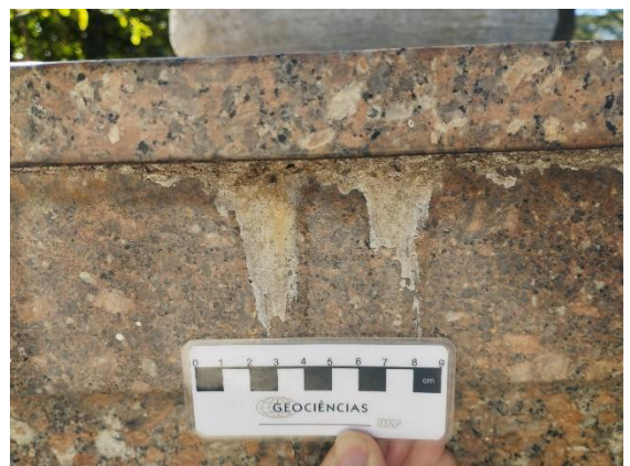
Figura 36: Incrustação de argamassa em túmulo de Granito Vermelho Salto.
