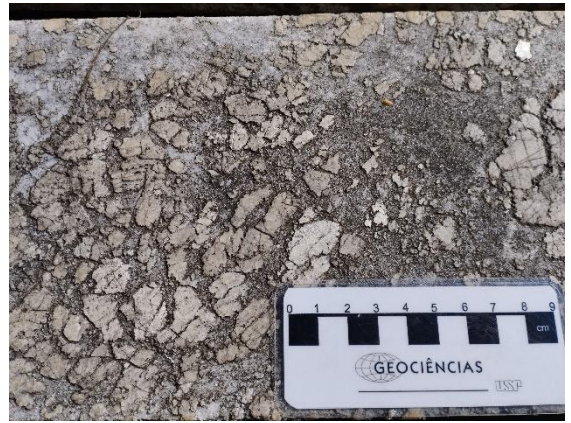
Figura 28: Erosão diferencial em túmulo de mármore.
