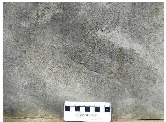
Figura 30: Riscos e fissuras em túmulo de mármore.
