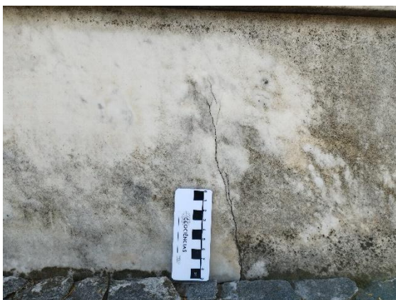
Figura 21: Fissura em túmulo de mármore.
