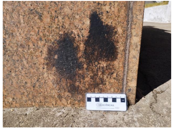
Figura 34: Depósito de fuligem em túmulo de Granito Rosa Itupeva.
