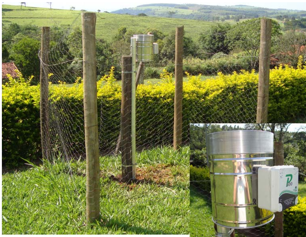
Figura 14: Primeiro pluviógrafo IRRIPUS instalado, na latitude de 22°26'03,46'' S, longitude 47°54'49.21'' W e altitude de 948 metros, no bairro do Palmital.
