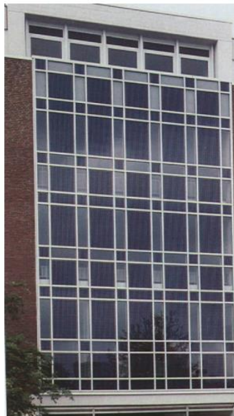
Figura 13 - Primeira fachada com sistema BIPV em Aachen, Alemanha. Fonte: Heinstei; Ballif; Perret-Aebi, 2013.
