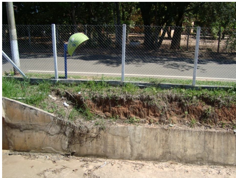
Figura 15 - Impacto 6 – perda de solo em talude de canal de drenagem pluvial
