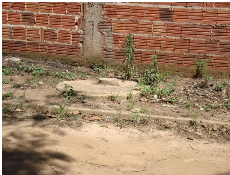
Figura 20 - Impacto 11 – poluição de solo e recurso hídrico por disposição inadequada de esgoto doméstico
