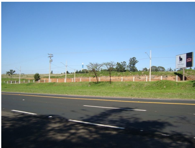
Figura 10 - Impacto 1 – perda de solo em um dos taludes laterais da pista
