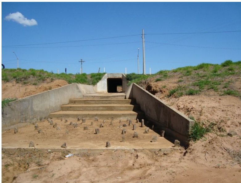
Figura 11 - Impacto 2 – perda de solo e acúmulo de sedimentos em bacia de contenção
