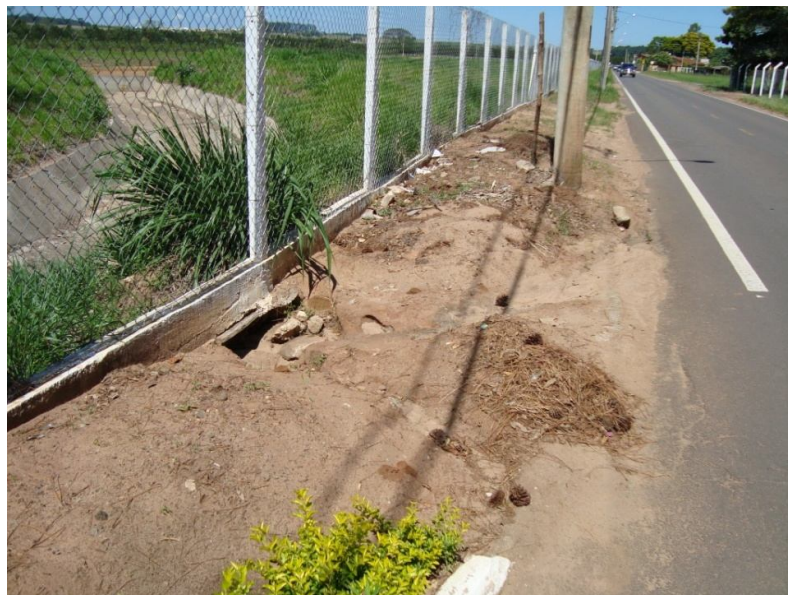
Figura 13 - Impacto 4 – perda de solo na entrada de bueiro para drenagem pluvial
