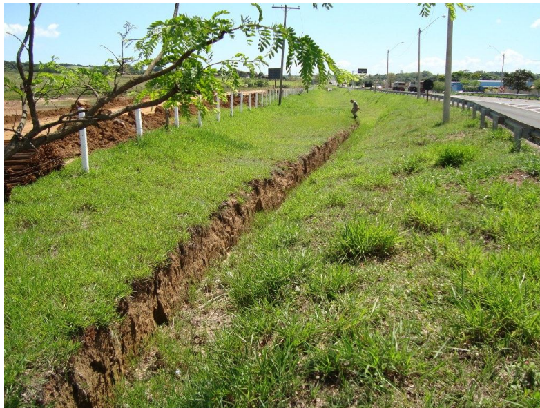
Figura 12 - Impacto 3 – perda de solo nas paredes laterais de canal de drenagem pluvial
