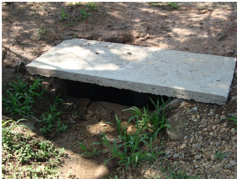
Figura 17 - Impacto 8 – perda de solo na entrada de bueiro
