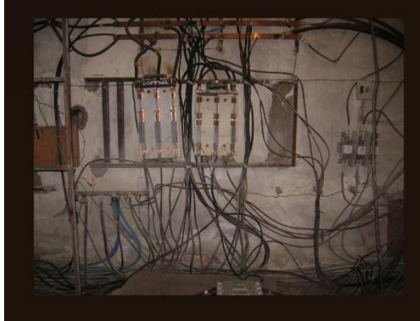
Figura 15 - Instalação elétrica mal feita
