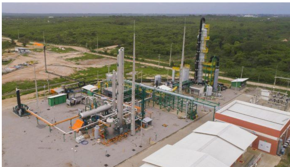
Figura 3 - Planta de tratamento de biogás da GNR Fortaleza
