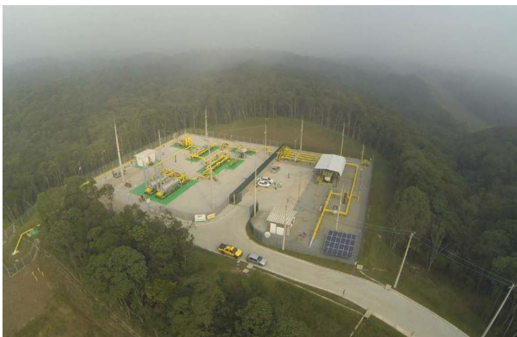
Figura 8 - Vista aérea de City Gate típico
