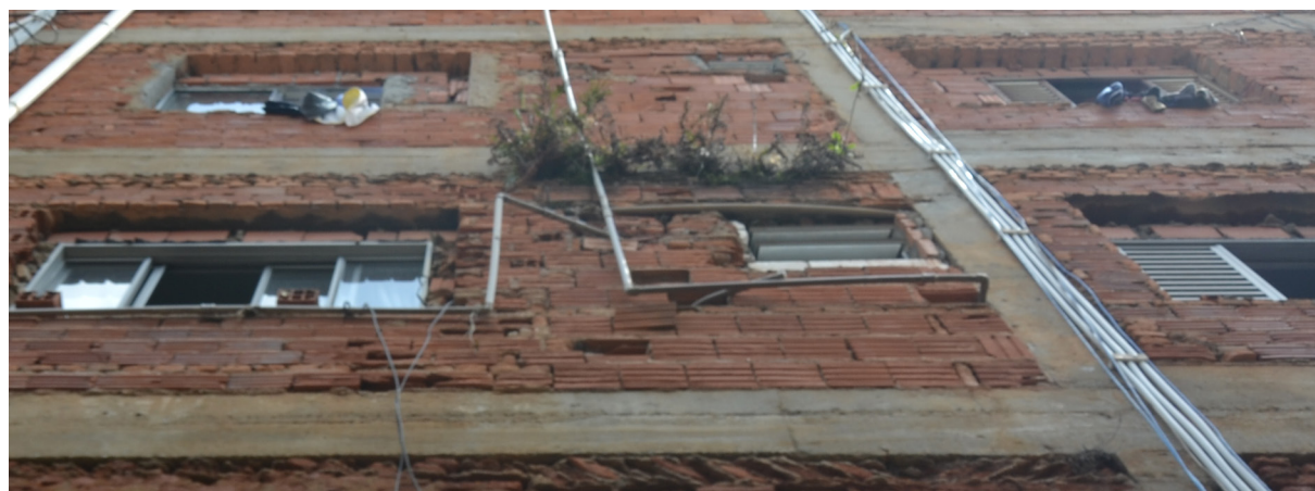
Imagem 34: Infestação vegetal na fachada | Fonte: Acervo pessoal | 2022
