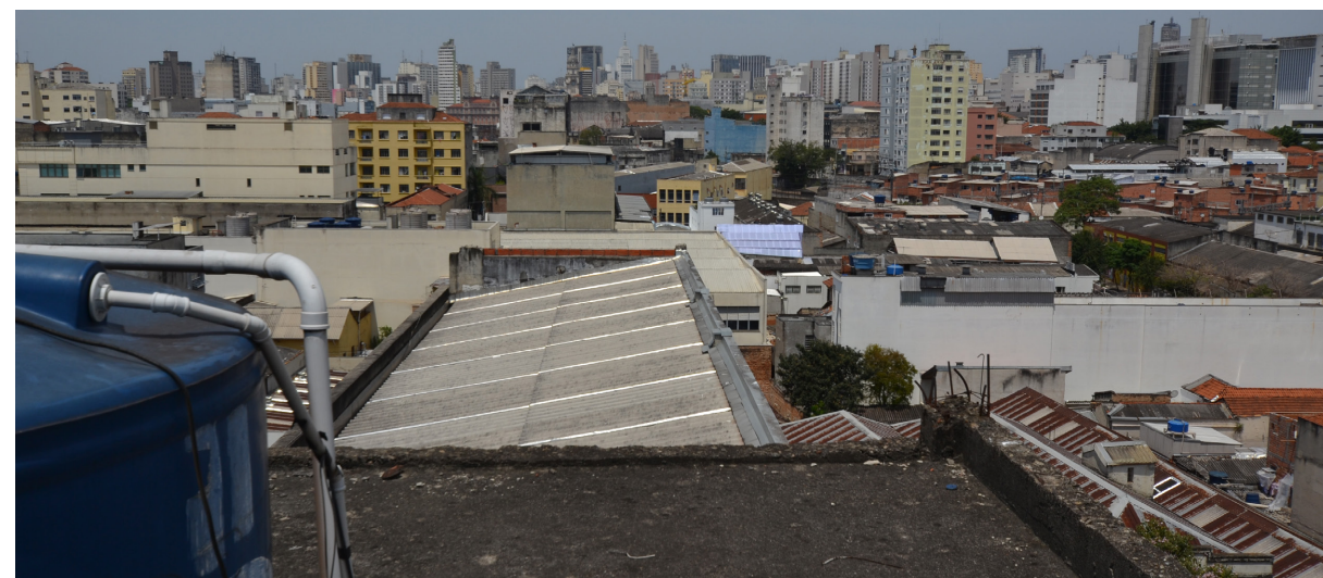
Imagens 19 e 20: Escombros do antigo 8º pavimento e vista da cobertura | Fonte: Claudia Oliveira | 2022
