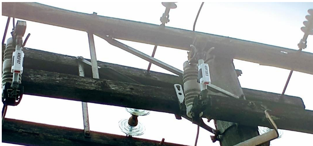
Figura 16 - Equipamento instalado na base fusível
