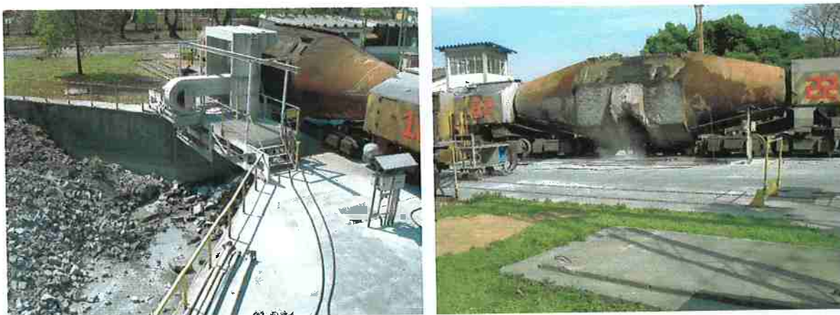
Figura 2.20. Estação de resfriamento e processo de limpeza à quente
