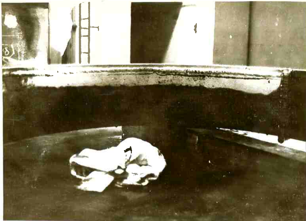
FIGURA 1 - Foto que mostra a trinca do flange estudado. (1)
