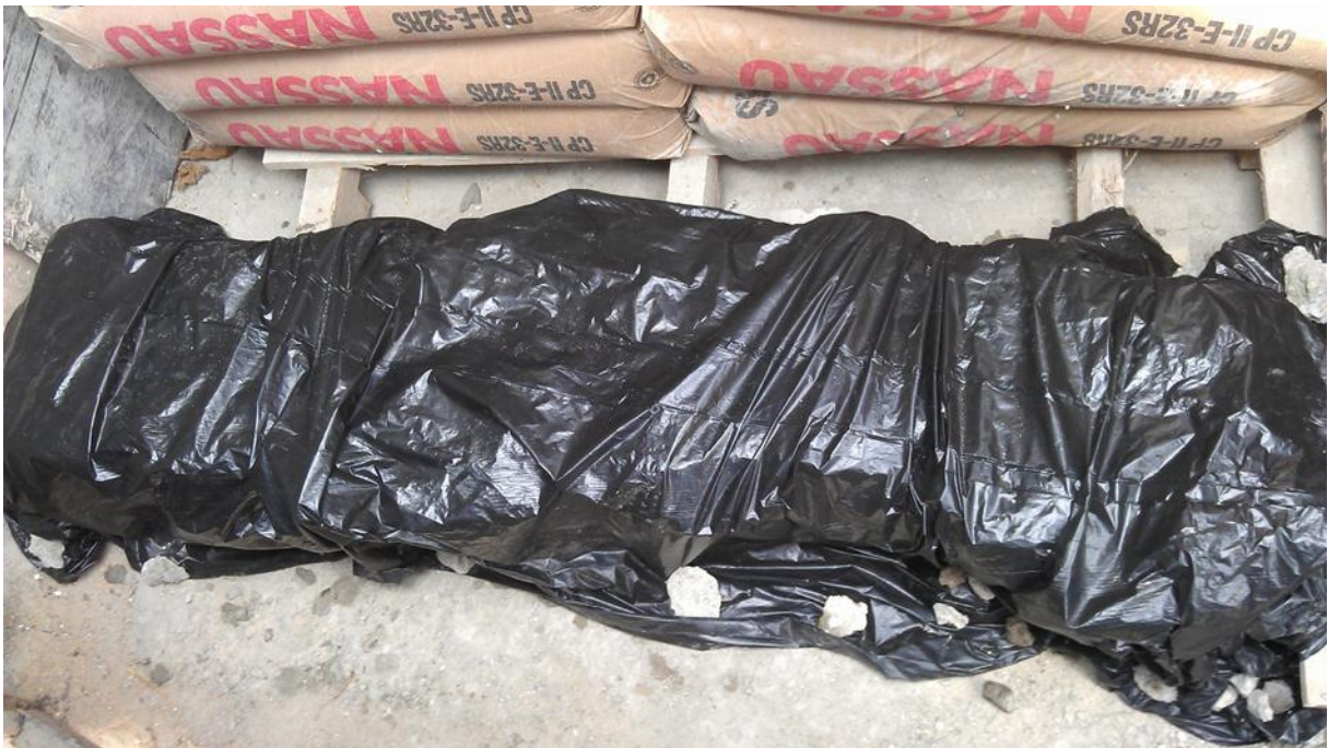
FIGURA 7: PROCEDIMENTO PARA MANTER UMIDADE E PROTEÇÃO DOS CORPOS DE PROVA NA OBRA
