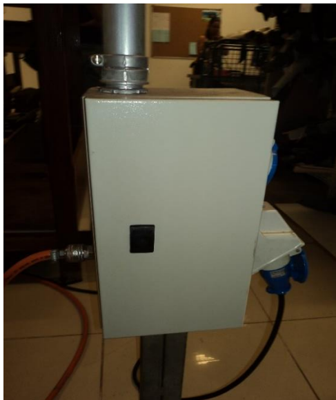
Figura 10 – Abastecimento elétrico e Ar comprimido da Máquina sem sinalização
