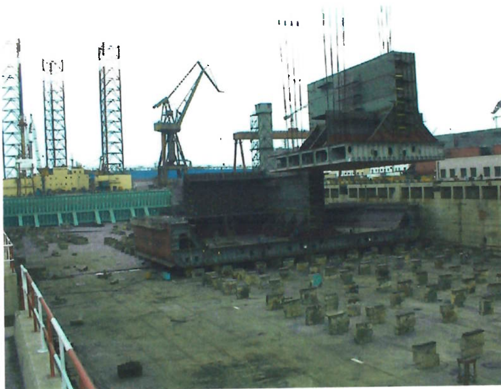
Figura 6 - Edificação de Blocos em Dique Seco (foto cedida pelo prof. Gerson Machado, 2010)
