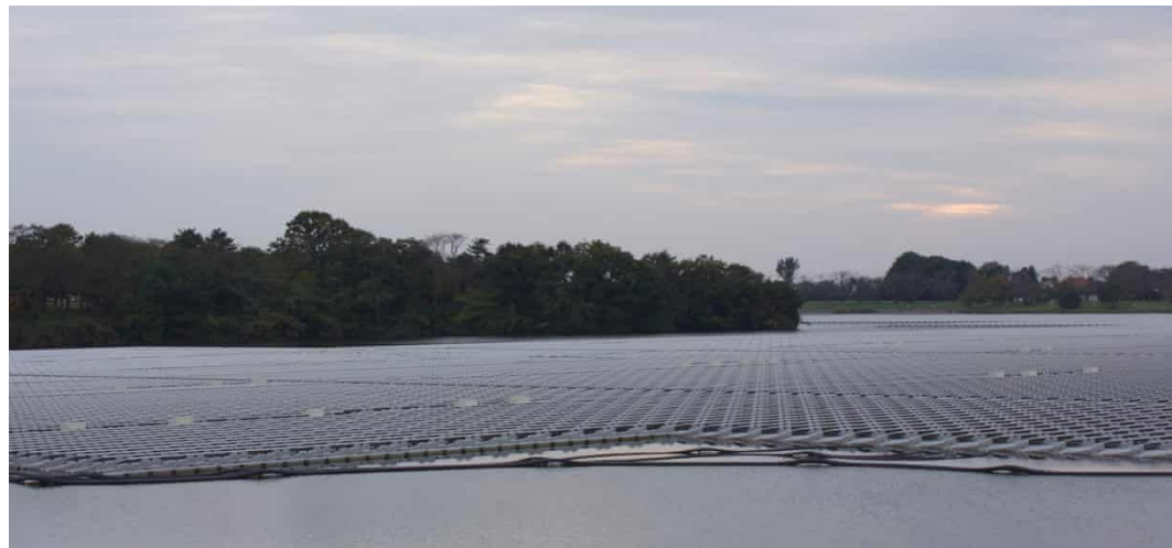
Figura 114: estação flutuante de geração de energia solar em Chiba, Japão.
